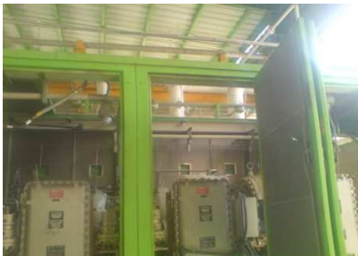
Figura 3.1 cabina de compresión abierta
