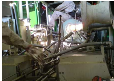
Figura 3.9 Tubos de alimentación de aceite.
