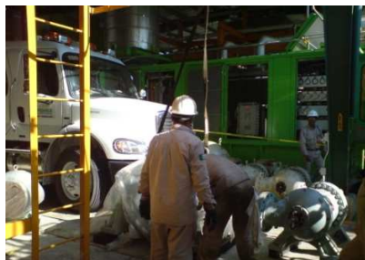
Figura 3.7 Compresores de media y alta presión de remplazo
