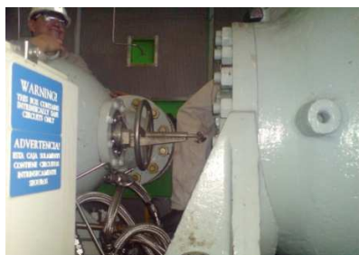
Figura 3.11 Alineación de compresores.
