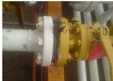
Figura 3.2 Ducto de gas comaleado
