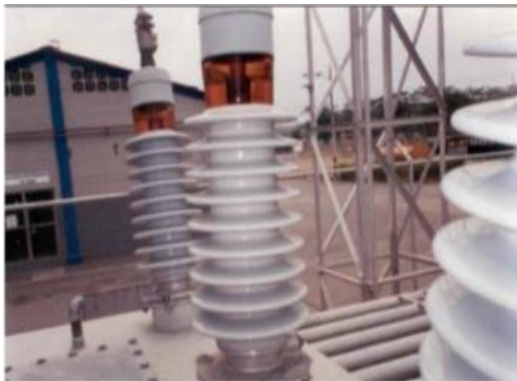
Fig. 8 Pasa-tapas de un transformador.
