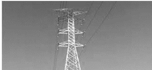
Fig. 2.3 Torres Autosoportadas Tubulares.
