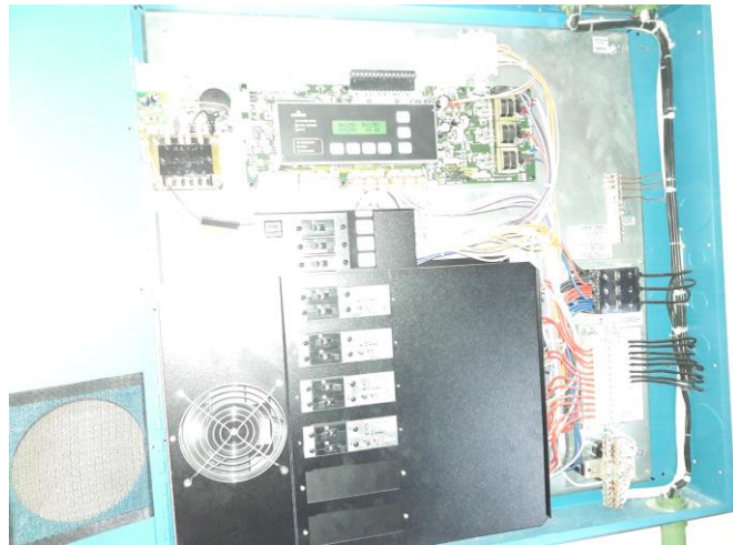
Imagen 26.- Dimmer Levitón A2000 para 24 circuitos.
