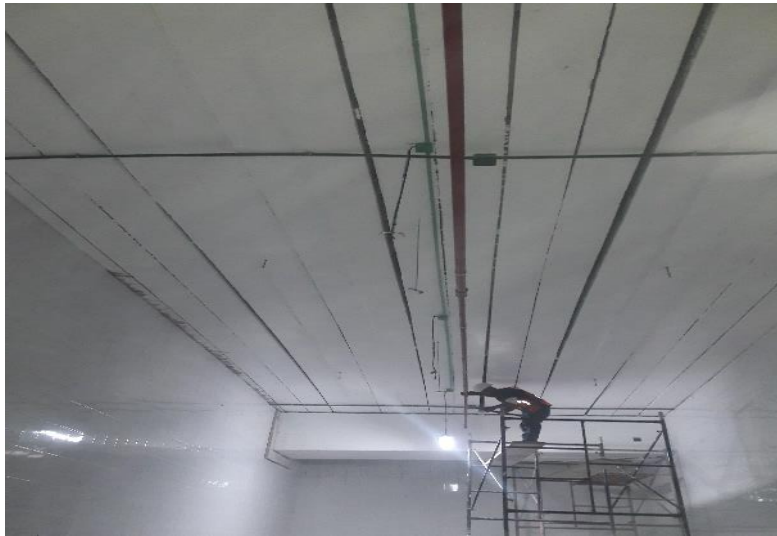
Imagen 16.- Canalización por techo con Tubería PVC.
