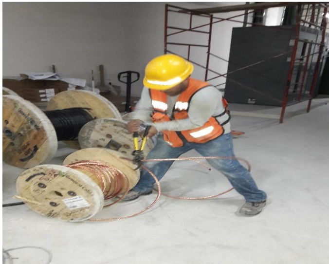
Imagen 40.- Cable de cobre desnudo, usado para toma a tierra en circuitos.
