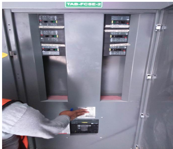
Imagen 19.- Tablero I-LINE instalado para el área de fuerza y cocina de los salones de eventos del Hotel Moon Grand Palace.
