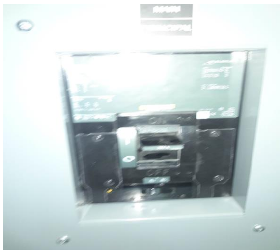
Imagen 24.- Interruptor Principal de 400 A para tipo marco L.
