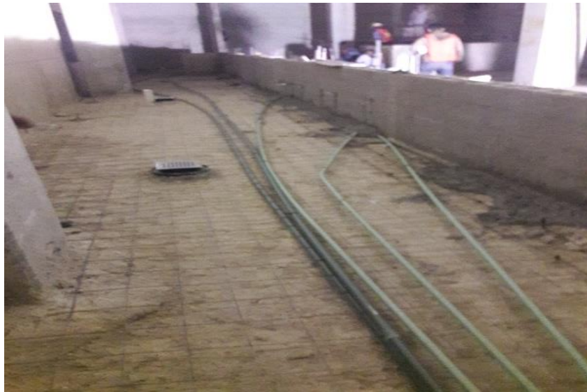
Imagen 15.- Canalización por Piso con Tubería PVC.
