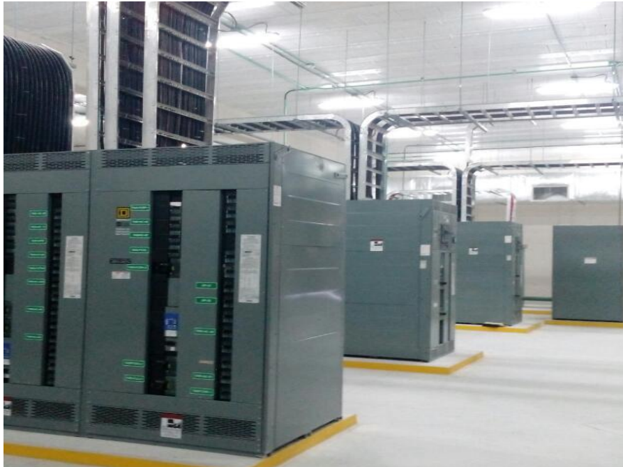
Imagen 2.- Transformadores en el Hotel Moon Grand Palace.
