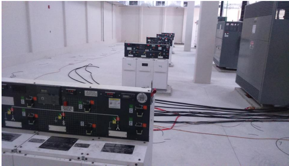
Imagen 30.- Seccionadores en el interior de la subestación J.
