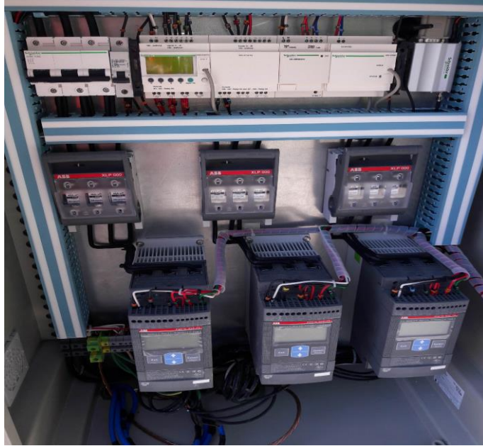
Imagen 39.- Interruptor automático termomagnético, protección contra cortocircuito.
