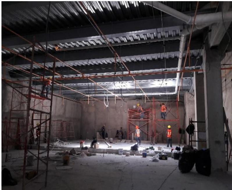
Imagen 11.- Inicios del proyecto de la obra eléctrica en el hotel Moon Grand Palace en Cancún, México.
