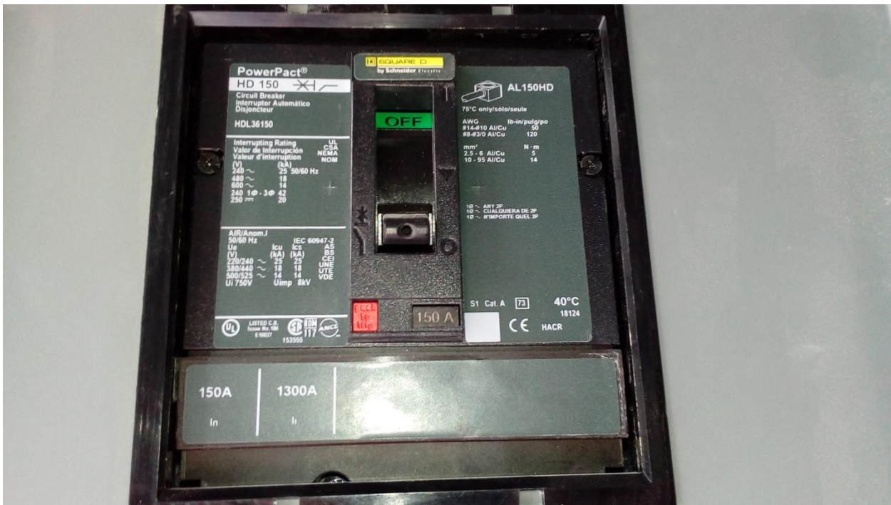
FIG.B.3: INTERRUPTOR TERMOMAGNETICO GENERAL 3X150A.
