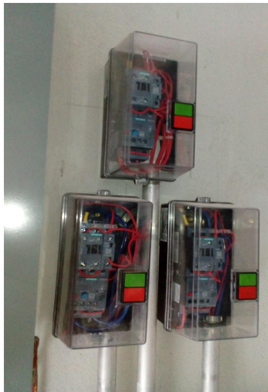
FIG.B.4: ARRANCADORES PARA MOTORES DE DESPACHO DE COMBUSTIBLE.
