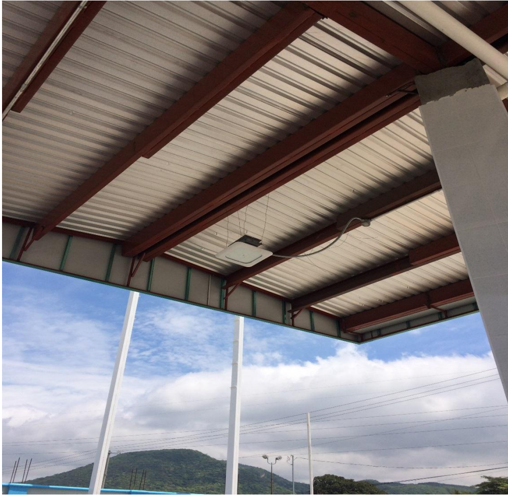
FIG.B.7 ALUMBRADO EN LA ESTACIÓN DE SERVICIO.
