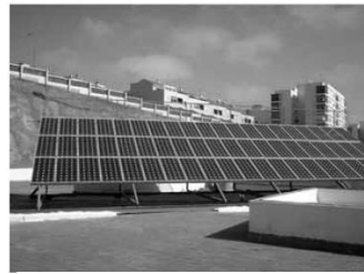
Figura 5.2 Paneles fotovoltaicos conectados a la red eléctrica.
