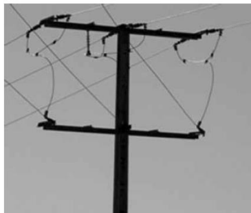
Figura 5.72 Poste existente en la parcela (ya modificado) de la compañía distribuidora para el punto de entronque.
