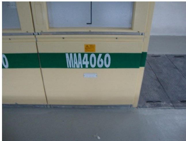
Figura. 21 Rotulado de la nomenclatura del alimentador en el Tablero alimentador Metalclad con gas SF6
