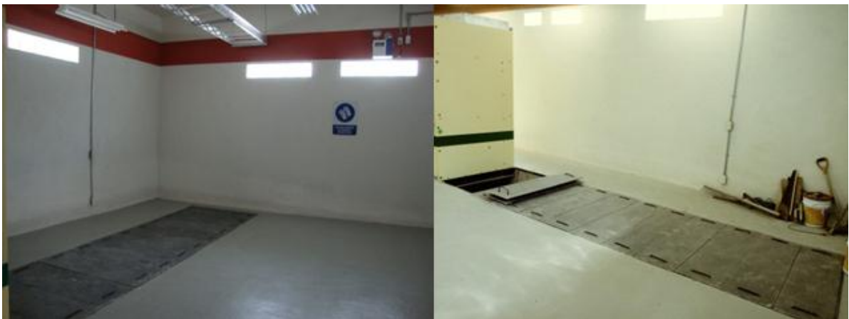
Figura. 19 Espacio y posición del nuevo Tablero Metalclad aislado en gas SF 6 de bajo la trinchera de A-MT 13
