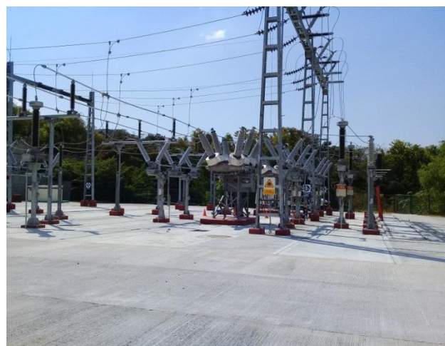
Figura. 11 Bahía eléctrica de la subestación de distribución Mactumatza
