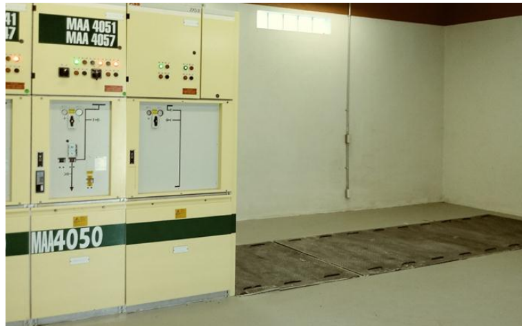
Figura. 20 Colocación e instalación de la sección de Tablero Metalclad con gas SF6 sobre la trinchera
