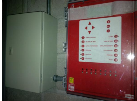
Fig. A 1.8 Cuadros de control y potencia de sistema de temperatura.
