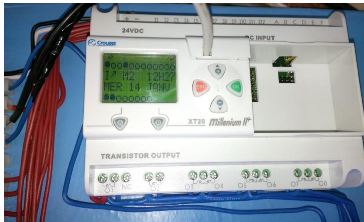
Fig. 3. 17 PLC en funcionamiento.
