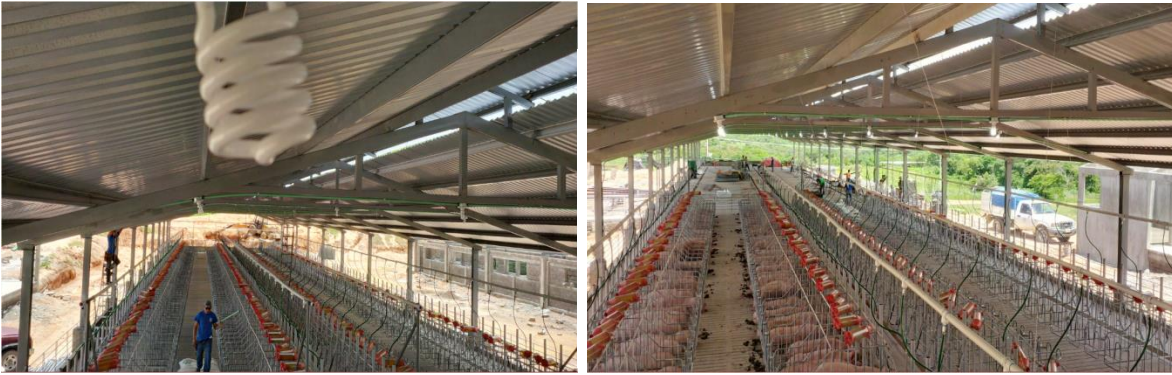
Fig.A1.4. Instalación eléctrica de galpón de gestación.
