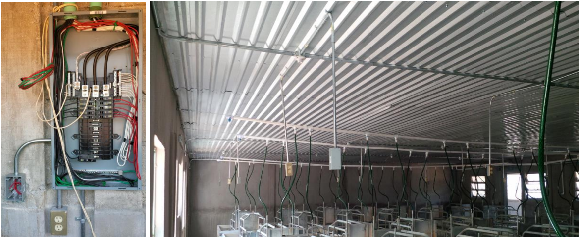
Fig. A 1.6 Tablero de distribución QO330L200G e instalación eléctrica dentro de la sala.
