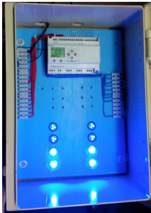
Fig. 3. 22 Focos del 1 al 4 encendidos por la señal captada del PLC.
