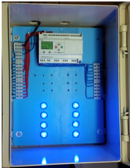
Fig. 3. 19 Sistema trabajando normalmente.
