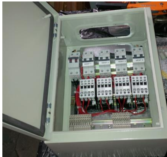
Fig. 3. 12 Modulo de control y protección.
