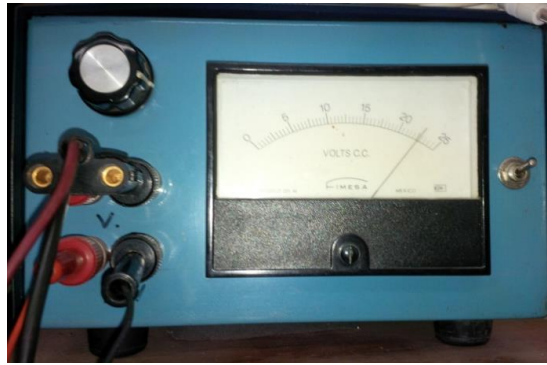
Fig. 3. 16 Fuente utilizada para la alimentación del PLC Crouzet.
