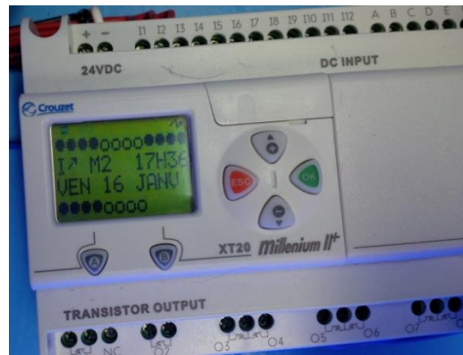
Fig. 3. 21 PLC identificando sus señales de entrada y salida.
