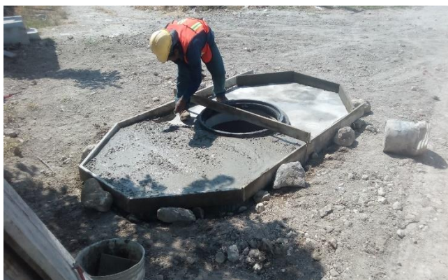
Figura 27 Instalación de aro y tapa de hierro fundido tipo 84A.
