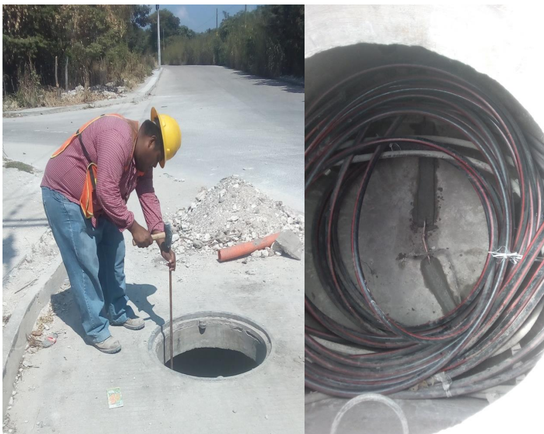
Figura 32 Instalación de Electrodo de tierra y conexión con el neutro corrido
