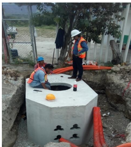
Figura 25 Instalación de pozo de visita de media tensión en arroyo tipo P
