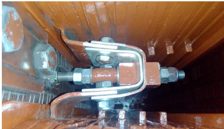
Fig. E.3. Conexiones eléctricas
