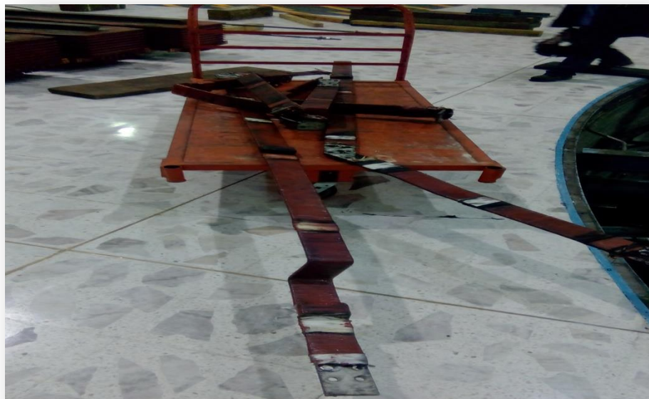
Fig. 3.27. Barras de excitación desmontadas
