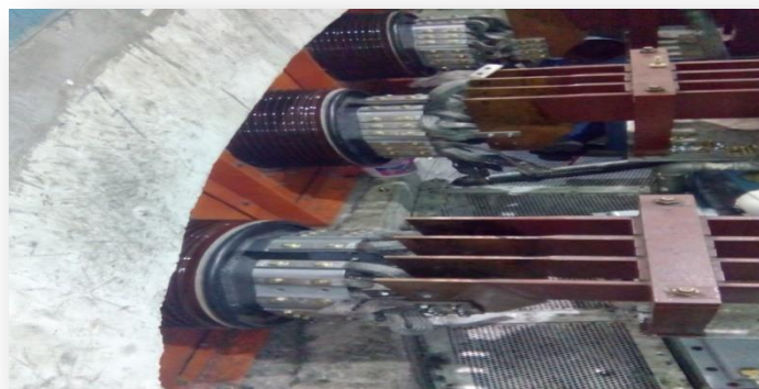
Fig. 3.34. Conexión de trenzas lado fase y neutro del generador
