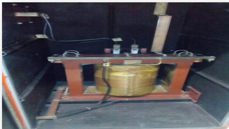
Fig. 4.5. Transformador neutro del generador
