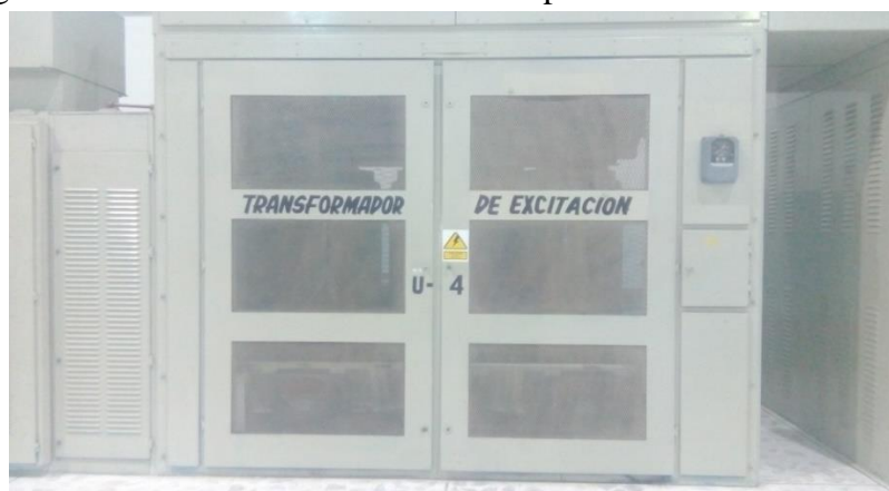
Fig.4.1. Transformador de excitación
