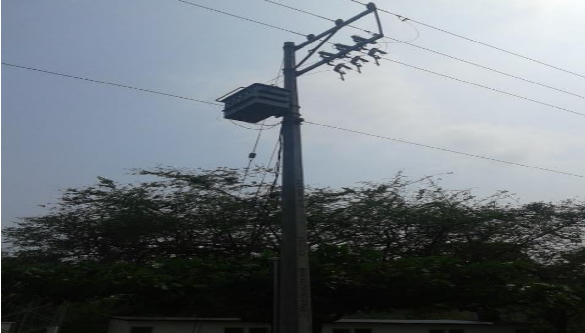
Fig.3.21 transformador conectado a la nueva red
