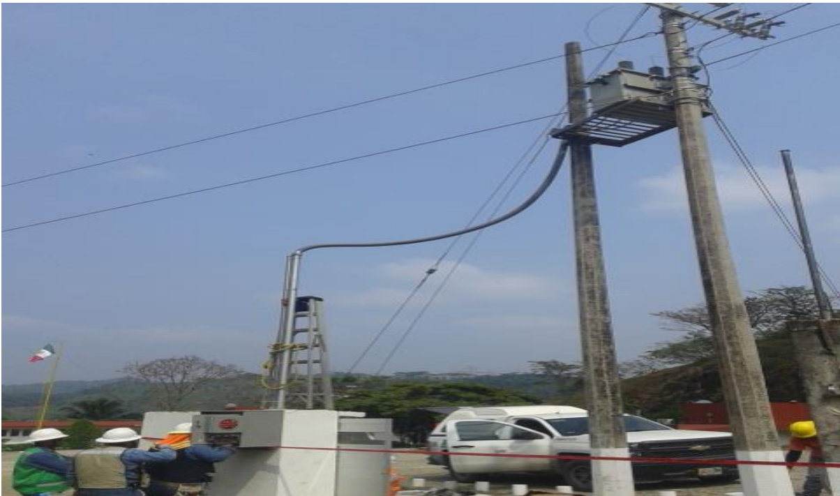
Fig.3.22 transformador conectado a la nueva red
