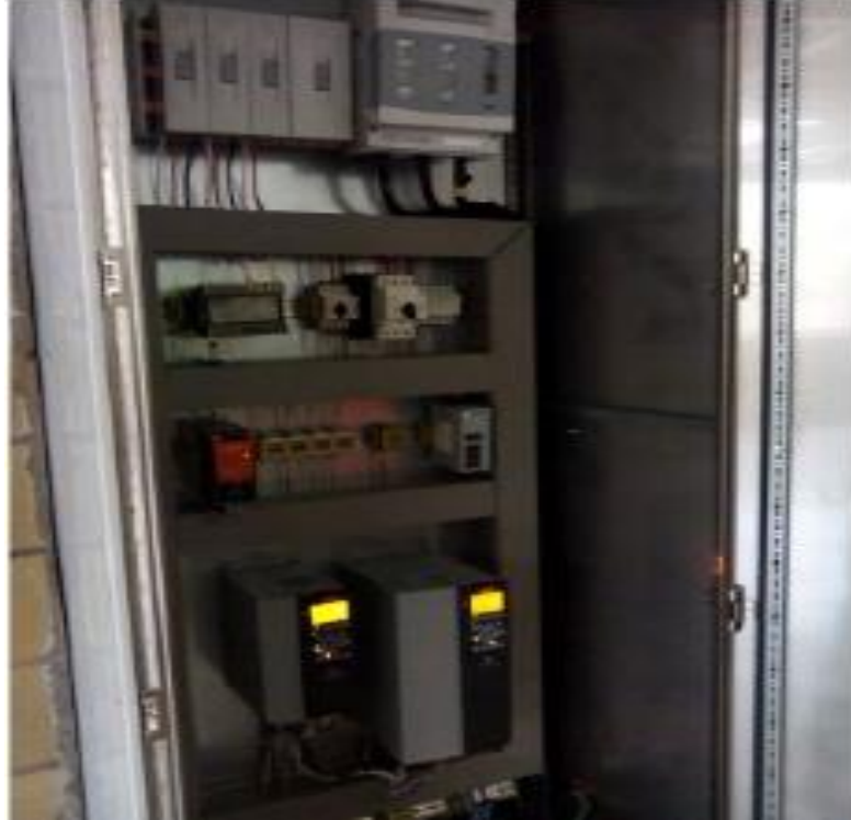
Fig. 5.4 Tablero de fuerza instalado en planta
