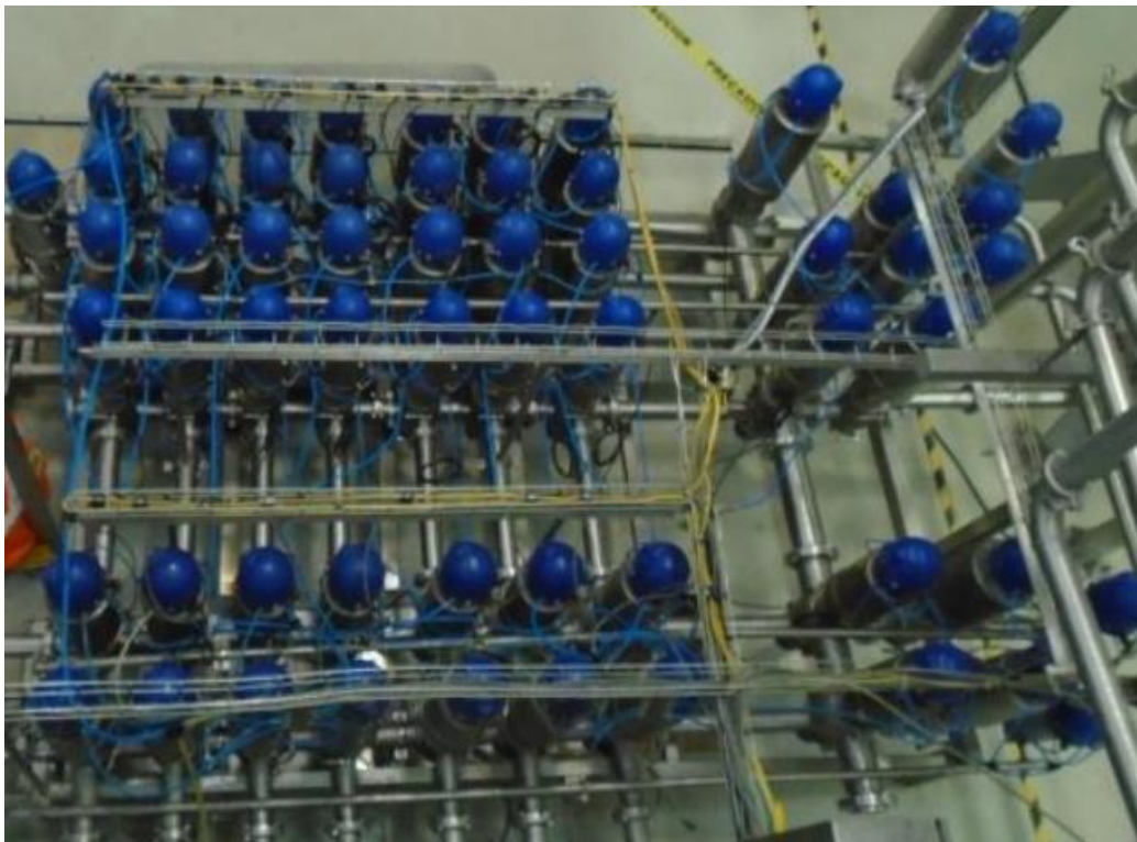
Fig. 5.2 Cabezal de válvulas clúster funcionando
