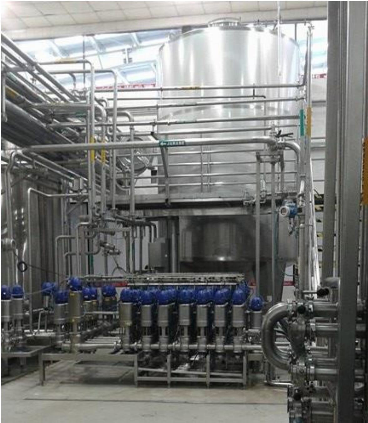
Fig. 5.3 Vista Frontal de Cabezal de Válvulas y Tanque Buffer con la instalación finalizada.
