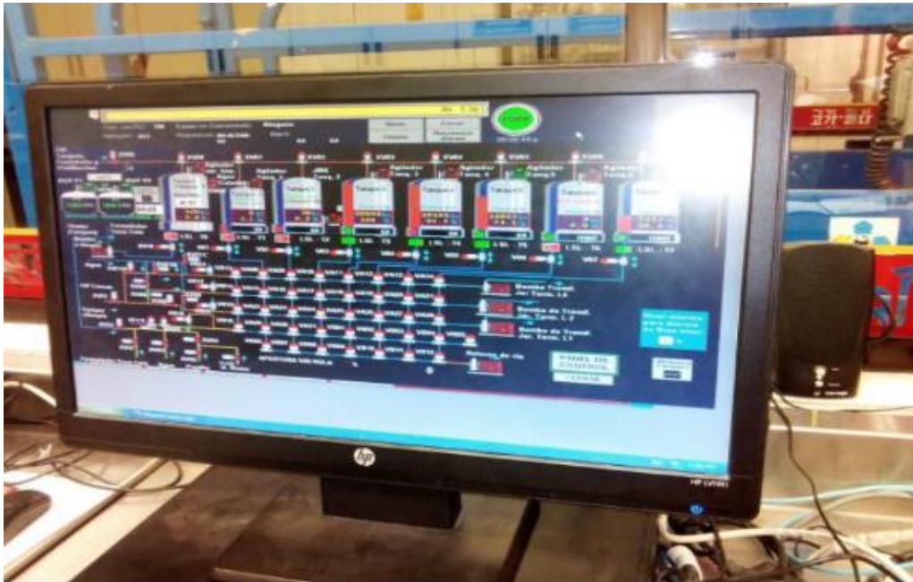
Fig. 5.1 Pantalla de control en planta (HMI) funcionando
