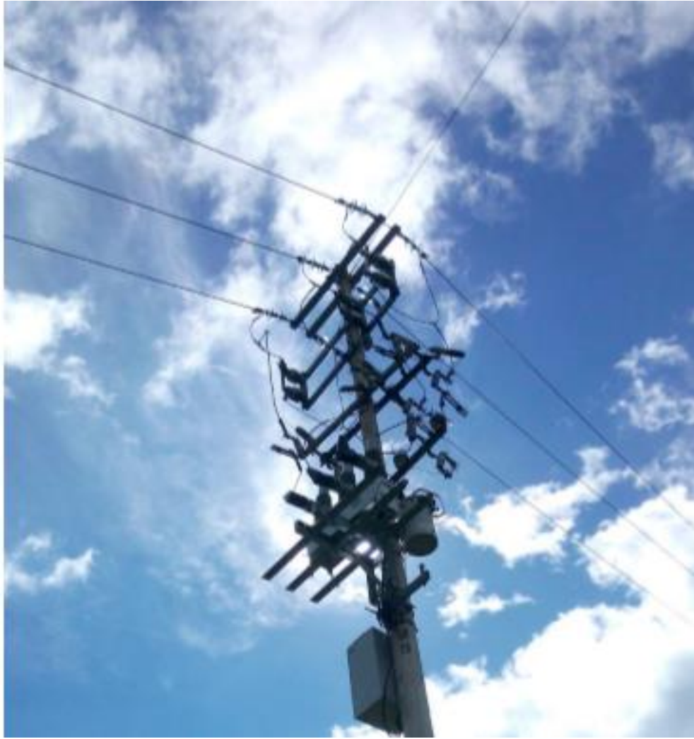
Fig. A.5 Restaurador instalado y en operación.
