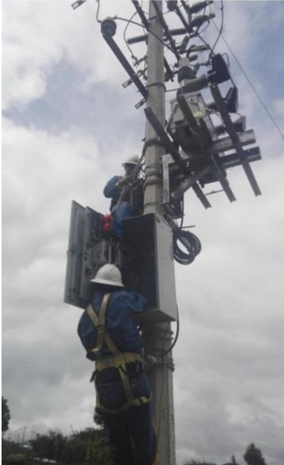
Fig. A.5 Programación del control del restaurador
