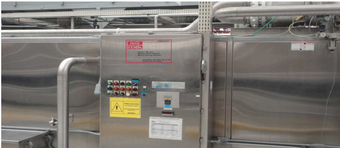
Figura 3) El atemperador de marca WARMER tiene la finalidad de atemperar las bebidas a 10 °C para su etiquetado ya que a esa temperatura aproximada es la que se recomendada para su correcta colocación.
