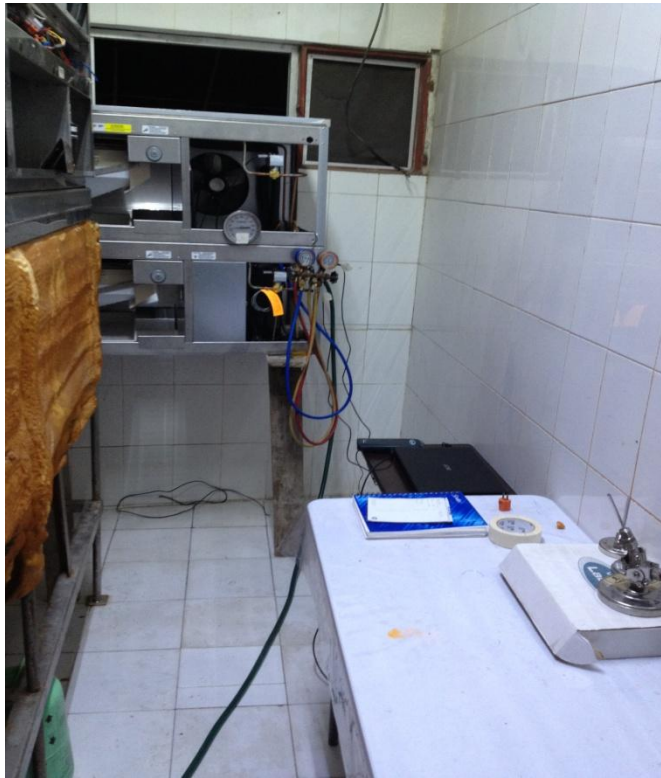
Figura 23. Cuarto de fabricación de hielo en cubo
