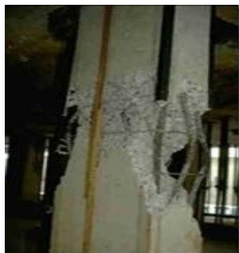
Figura 30 Falla en la columna
