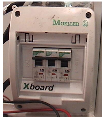
Figura 71. Interruptor principal, encendido.
