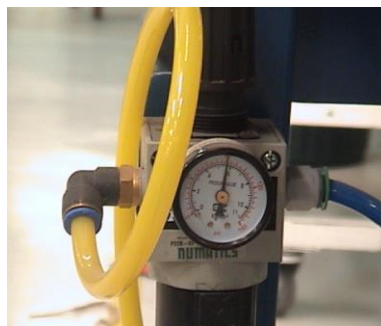
Figura 27. Filtro y medidor de presión.
