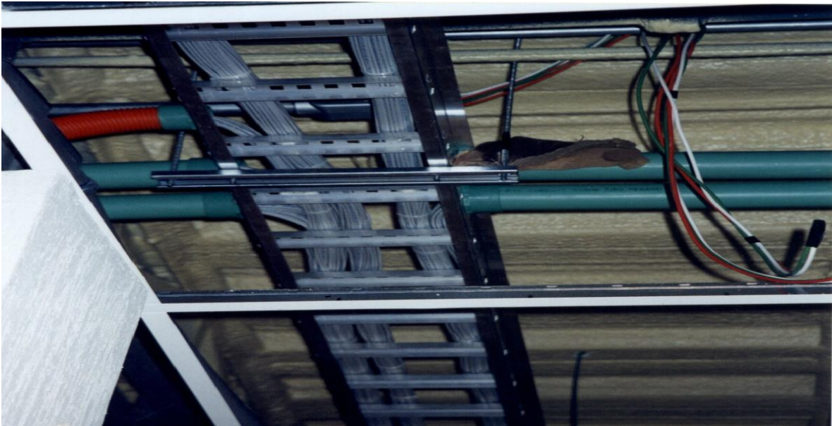
Cables instalados en las escalerillas.
