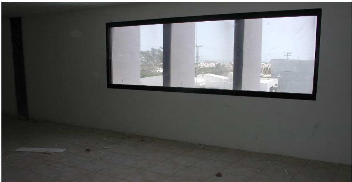
Adecuación del área donde se instalarán los equipos de comunicación de voz y datos.
