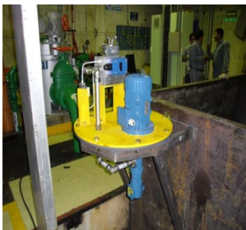
Fig 3.37 Sistema de enfriamiento de aceite del deposito vk 300
