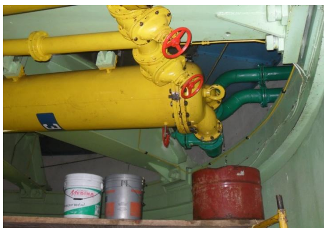
Fig. 3. 27 Intercambiadores de calor de la chumacera guía combinada
