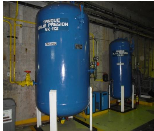
Fig. 3.33 Tanque vk 112 (aire baja presión)
