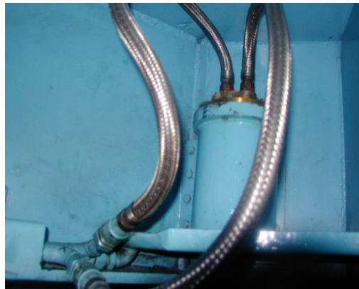
Fig. 3.25 Enfriador de aceite de la chumacera guía generador
