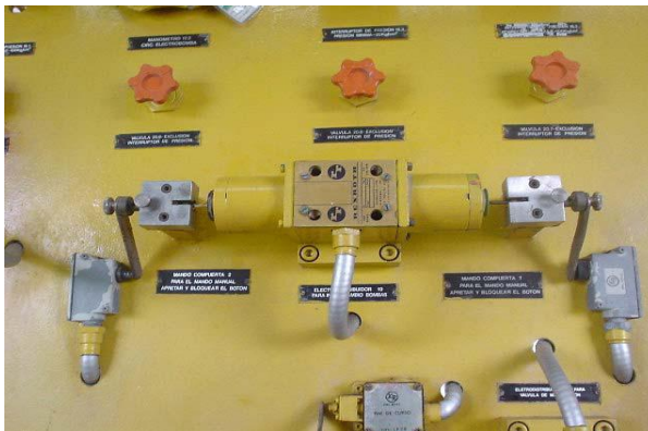
Fig. 4.28 Electro distribuidor 19 Para intercambio de bombas
