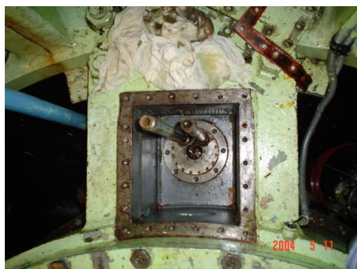
Fig. 3.30 Enfriadores de la chumacera guía turbina
