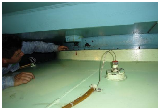
Fig. 3.24 Interior de la chumacera guía generador
