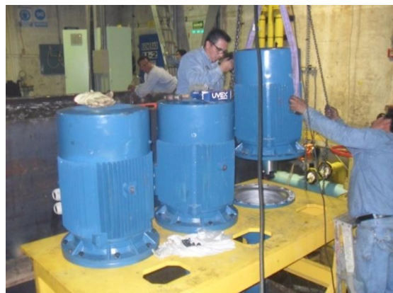
Fig. 3.36 Bombas de regulación
