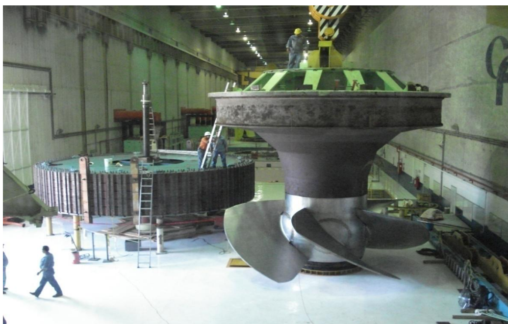
Fig. 3.1 Rodete de la turbina Kaplan
