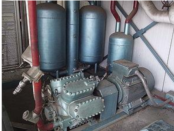
Fig. 1.5) Compresor industrial para refrigerante R22
