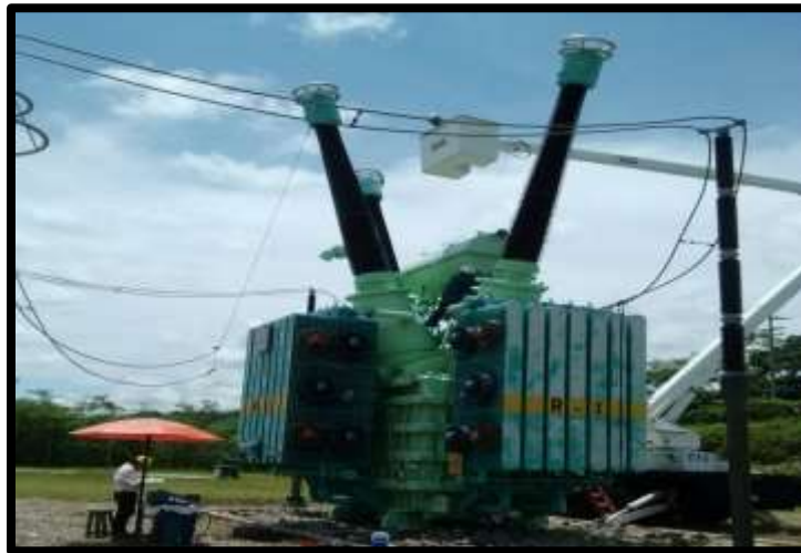
Foto 4. Personal de CFE haciendo pruebas eléctricas al Reactor eléctrico de Potencia 62 MVAR
