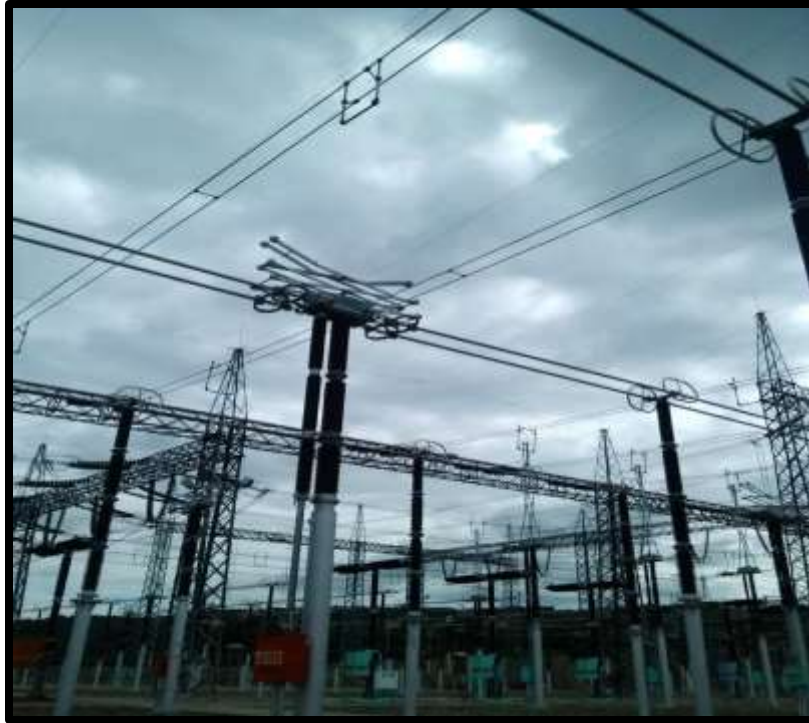
Foto 7. Cuchilla tipo Pantografo-Vertical 400 KV
