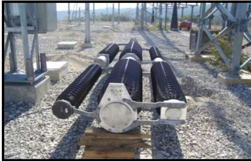
Foto 16. Inspección visual de los interruptores de potencia 400 kV, verificando cámaras de extinción de arco y columnas
