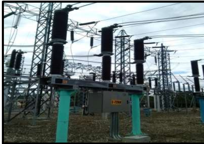
Foto 6. Interruptor de Potencia con 3 polos. (115 KV)
