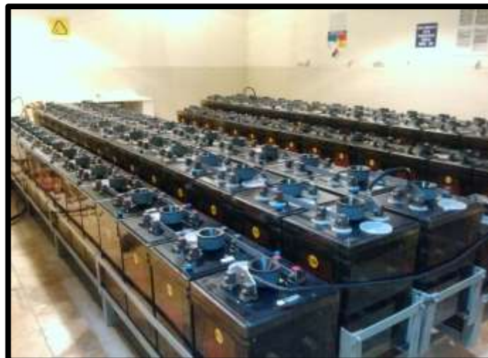
Foto 11. Banco de baterías marca ESB de 250 Vcd para bahía A3T30
