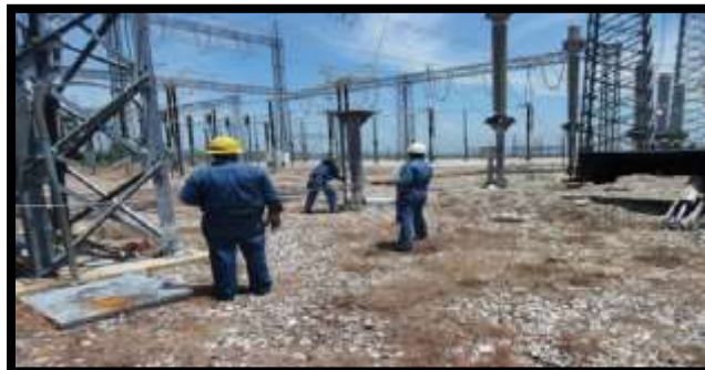
Foto 14. Personal de CFE realizando tendido de conductor a barras bus e hilo de guarda.
