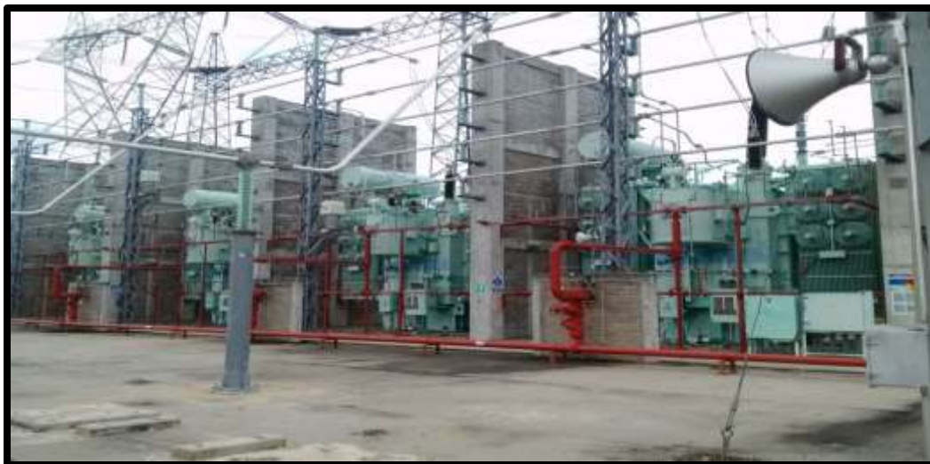
Foto 3. Banco de Transformación T-6
