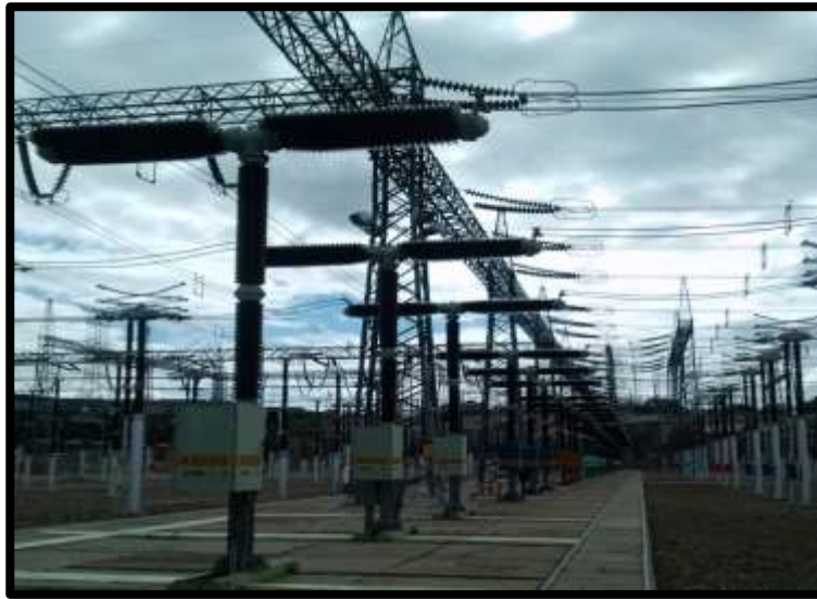
Foto 5. Interruptores de Potencia doble cámara 400 KV.
