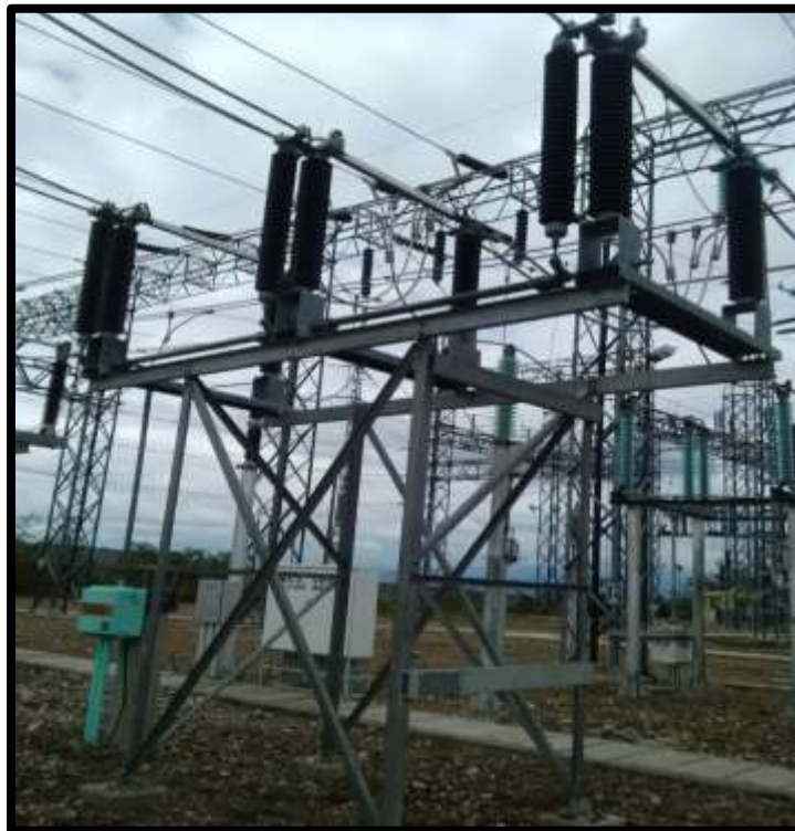
Foto 8. Cuchilla Vertical 115 KV.
