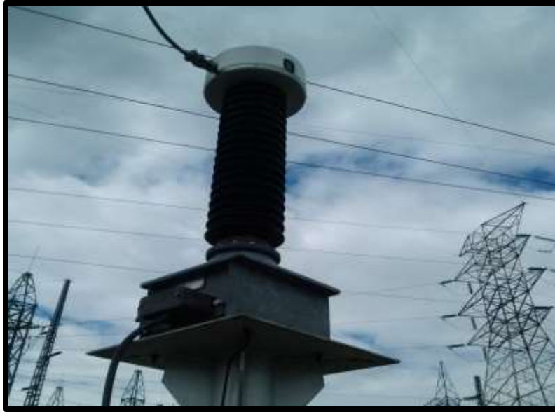
Foto 10. Dispositivo de Potencial Capacitivo (DPC) 115 KV.
