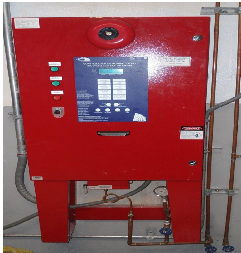
Fig. 8.5.2 Tablero de control del equipo contra incendio
