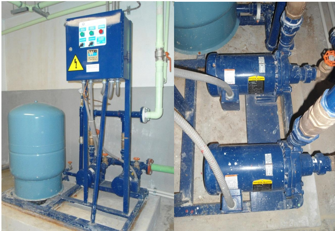
Fig. 8.1.3 Sistema hidroneumático dúplex
