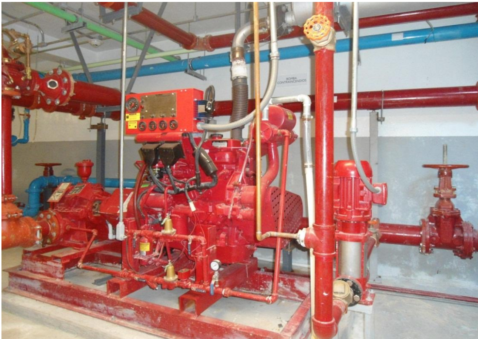
Fig. 8.5.1 Equipo contra incendio
