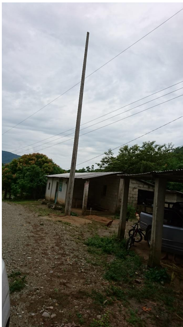
Fig. 6 Parado de poste de concreto reforzado 12-750 plomeado y alineado con los otros postes.
