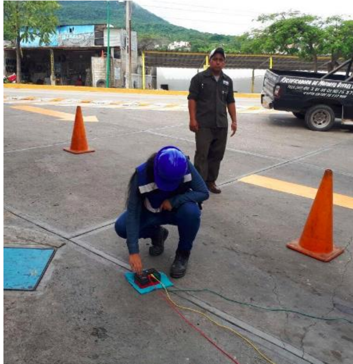
Fig. A2 Medición de tierra electrodo de dispensario
