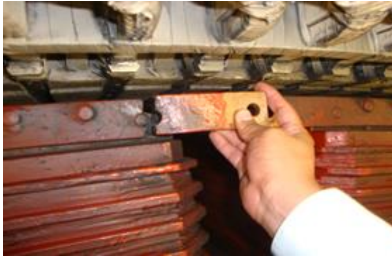
Figura 3.85 Barra Amortiguadora Fisurada
