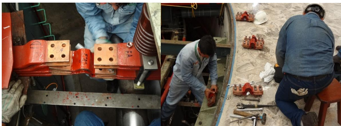
Figura 3.9 Desconexión de las trenzas del generador
