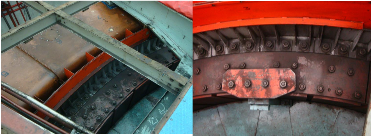
Figura 3.4 Generador sucio de polvo de balata
