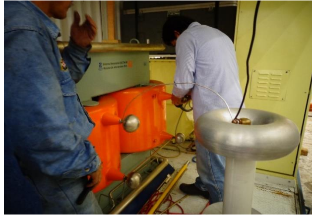
Figura 3.33 Instalación del equipo para la prueba de alta tensión
