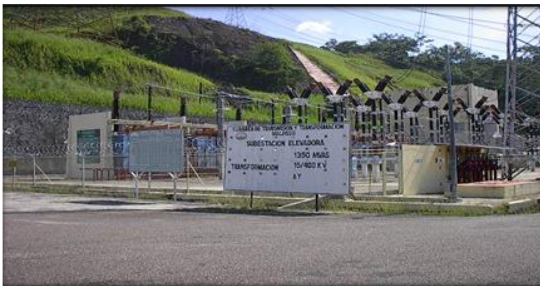
Anexo 6.6 Subestación elevadora
