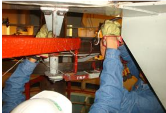
Figura 3.75 Colocación del potencial para la prueba en corriente alterna
