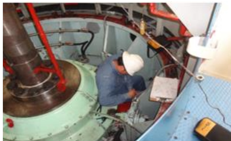
Figura 3.156 Reubicación de cableado correspondiente a soportes aislantes de chumacera guía generador, fijación de tablillas y conexión de cableado en área de soportes.
