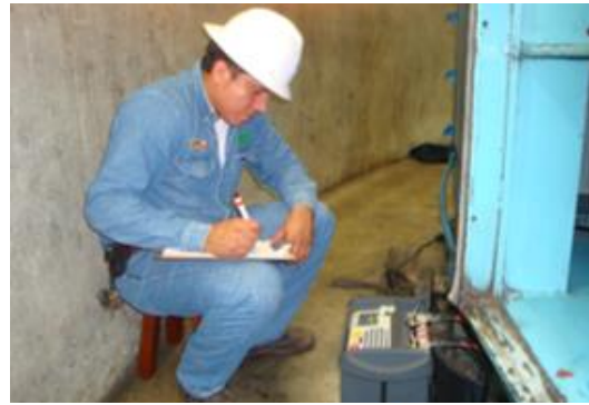
Figura 3.146 Prueba de resistencia de contacto parte inferior
