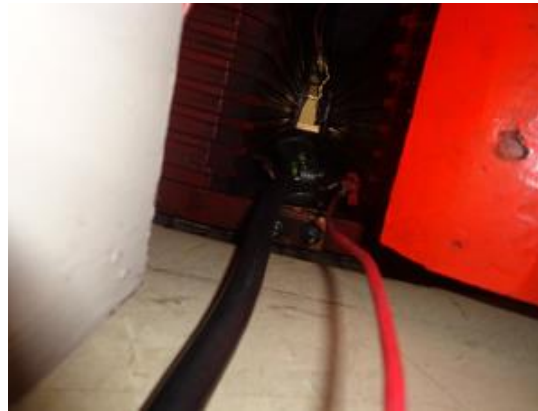
Figura 3.147 Conexión de los caimanes de prueba
