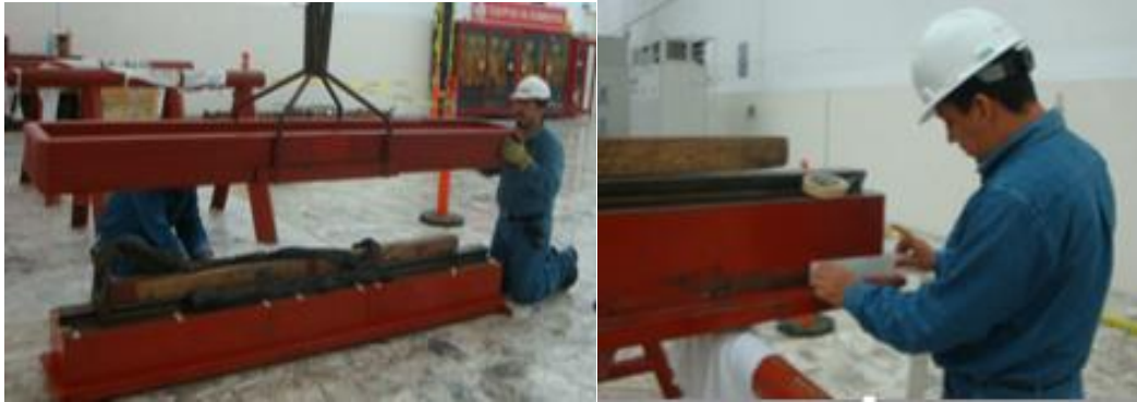
Figura 3.97 Desarmado de polo 35 para darle mantenimiento
