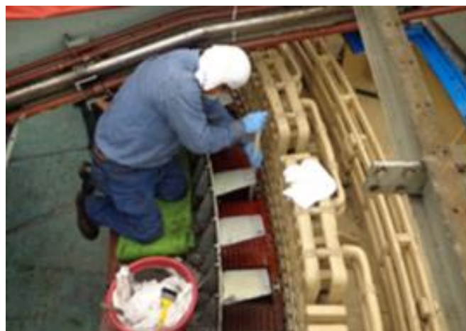
Figura 3.120 Limpieza de los polos montados parte superior y aspas de ventilación.
