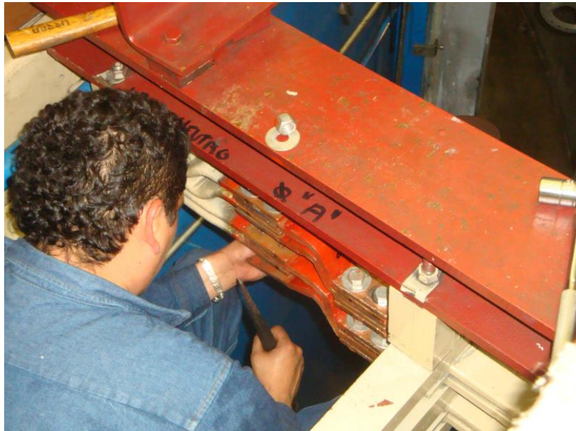
Figura 3.24 Conexiones de las trenzas lado Fases
