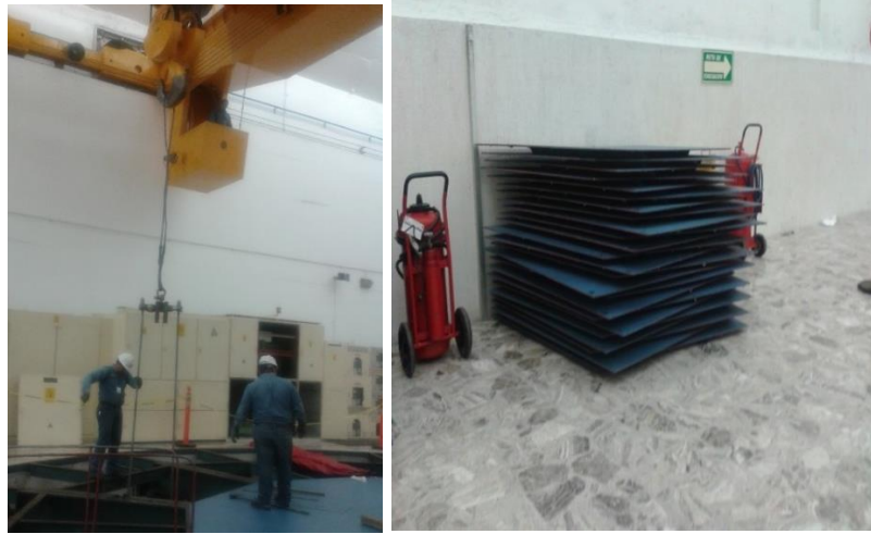
Figura 3.2 Desmontaje de tapas antiderrapantes
