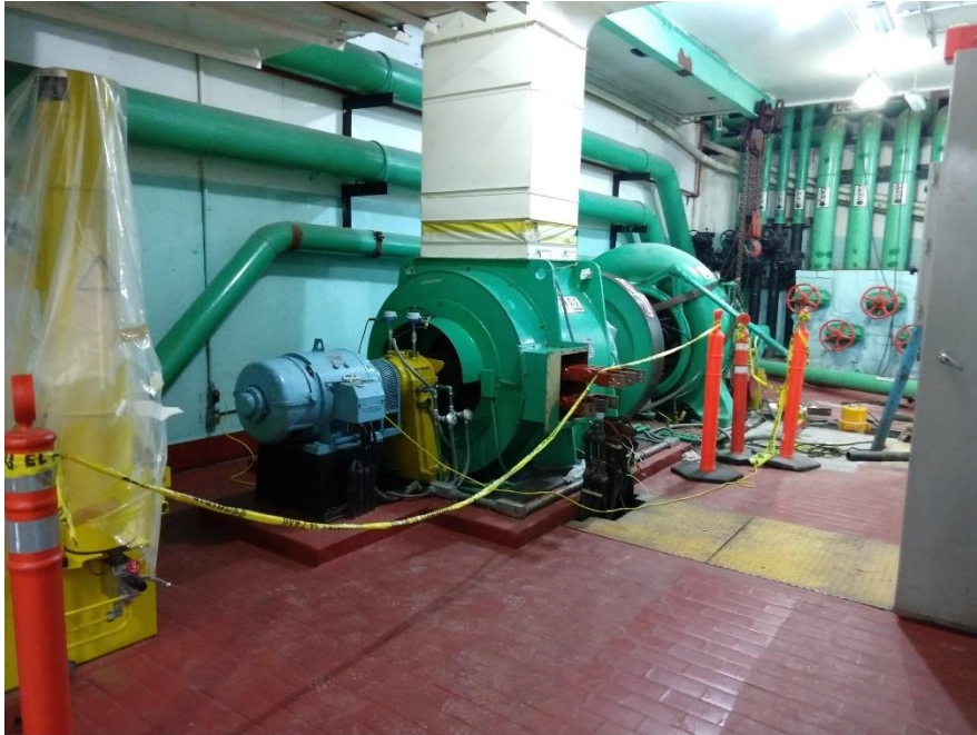
Anexo 6.14 Generador trifásico auxiliar
