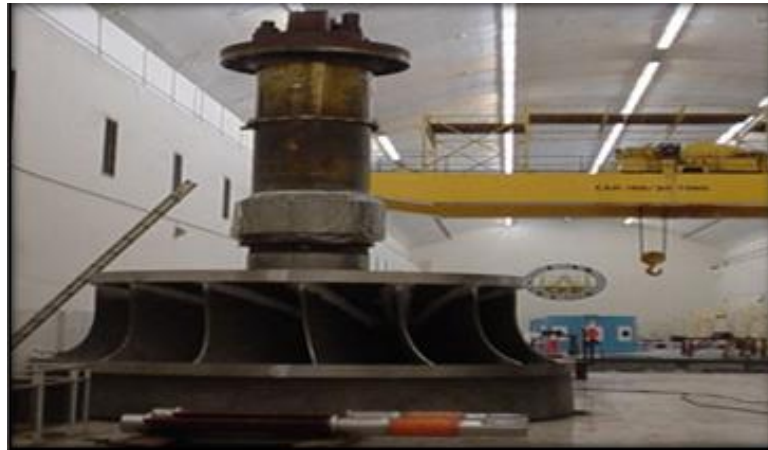
Anexo 6.15 Turbina tipo Francis de la unidad #3
