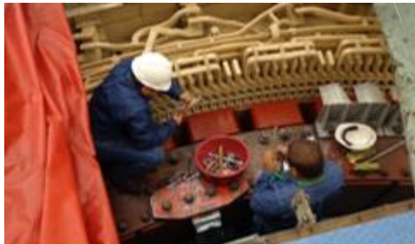
Figura 3.137 Cambio de tornillería parte superior de polo
