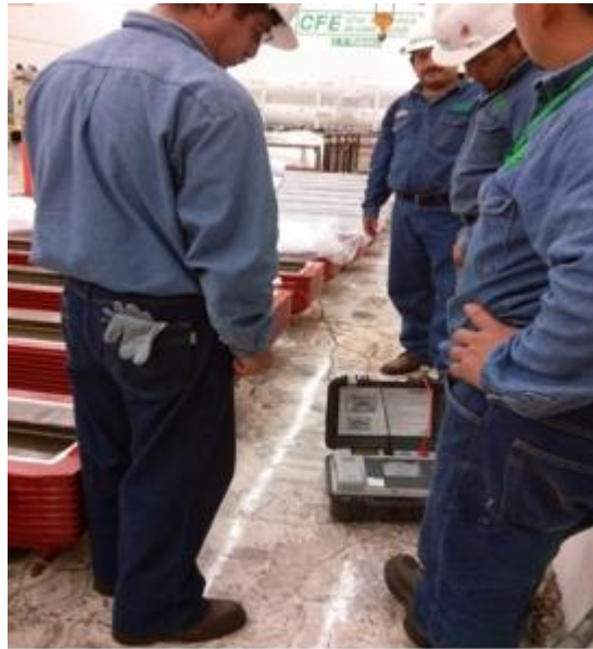
Figura 3.119 Prueba de resistencia de aislamiento a los polos corregidos
