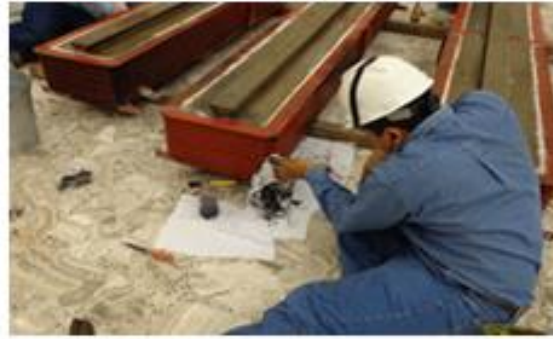
Figura 3.101 Limpieza de polos desmontados
