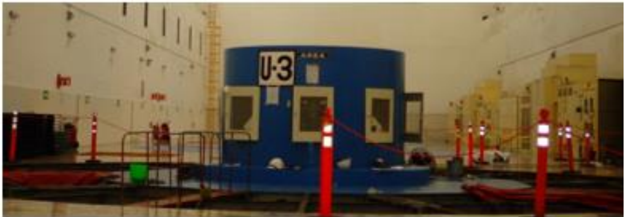
Figura 2.33 Generador Síncrono de 180 MW
