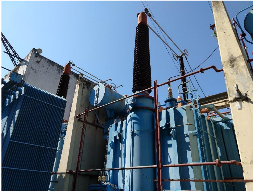
Figura 3.172 Transformador Monofásico, fase C de la unidad #3.
