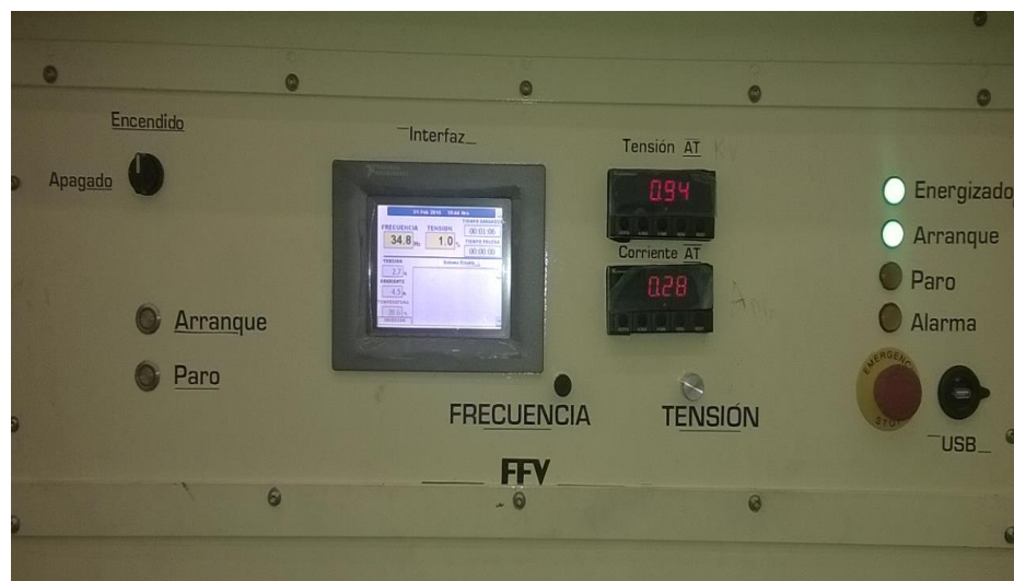
Figura 3.35 Inicio de la prueba de alto potencial
