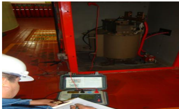
Figura 3.27 Prueba de resistencia de aislamiento al conjunto de generador-transformador
