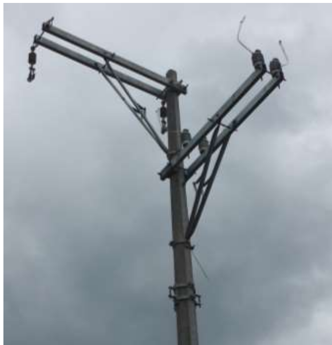
Fig. A.4 en el primer nivel del poste se observan las estructuras de media tensión VR (volada de remate) Y VD (volada doble), debajo de las estructuras primarias se localiza la estructura de baja tensión 1R1/1R1/1R1
