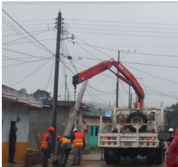
Fig. A.2 parado de poste con grúa hidráulica ejecutado con cuadrilla ayudante
