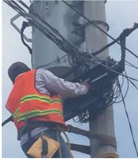
Fig. A.8 colocación e instalación de cajas antifraudes para acometida
