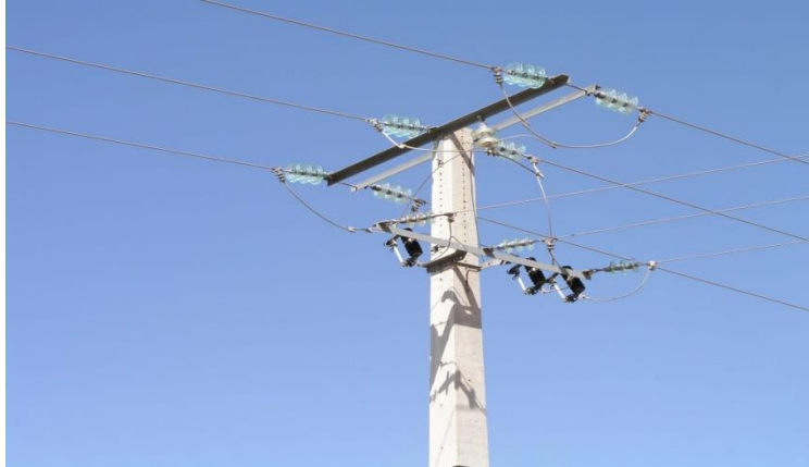
Fig. 2.2.2 Red Eléctrica de Media Tensión.
