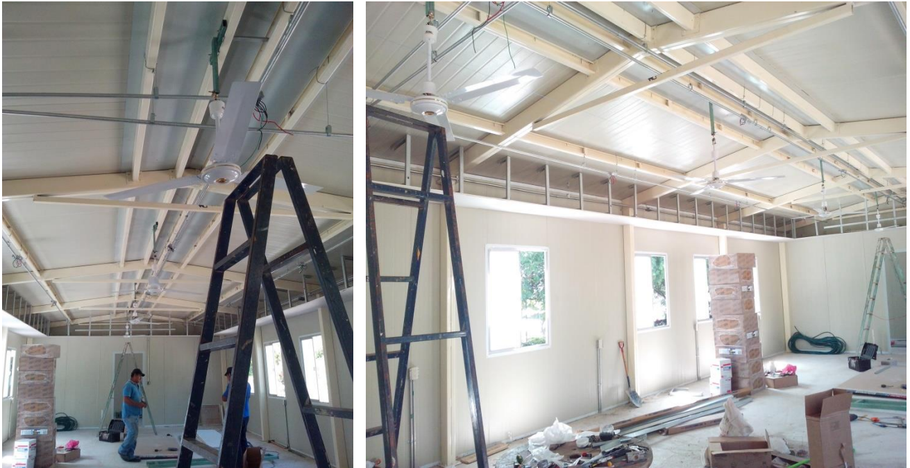
Fig. 3.2.8 Instalación de ventiladores. VENTILADOR BIRTMAN 100W BLANCO DE 3 ASPAS MOD. CF – 561.
