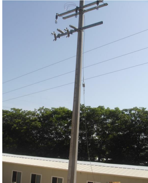
Fig. 3.1.20 Protecciones se Sobre-Voltajes y Protecciones de Sobre-Corrientes.
