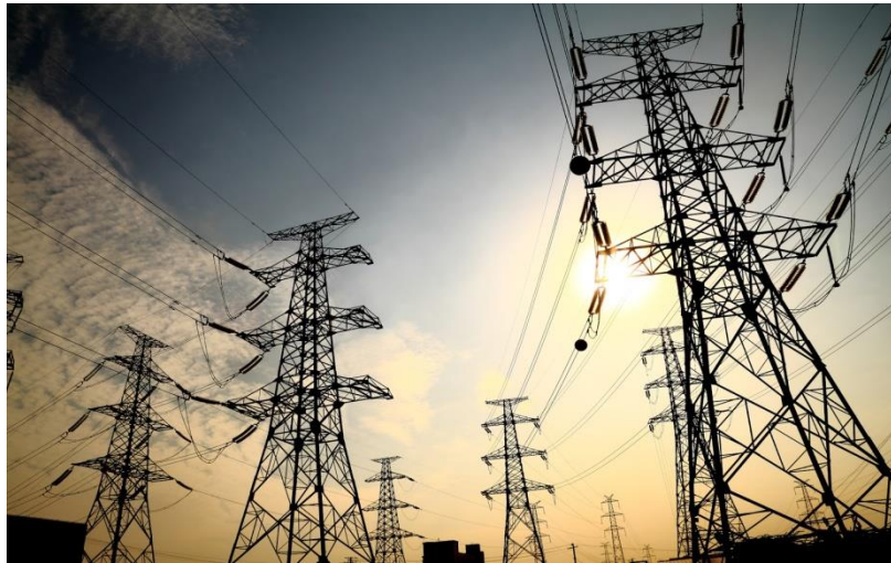
Fig. 2.2.1 Red Eléctrica de Alta Tensión.
