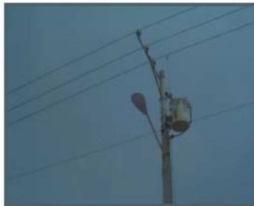
Figura 1.1.- línea de distribución en MT (13.2kV) convencional con conductor desnudo.
