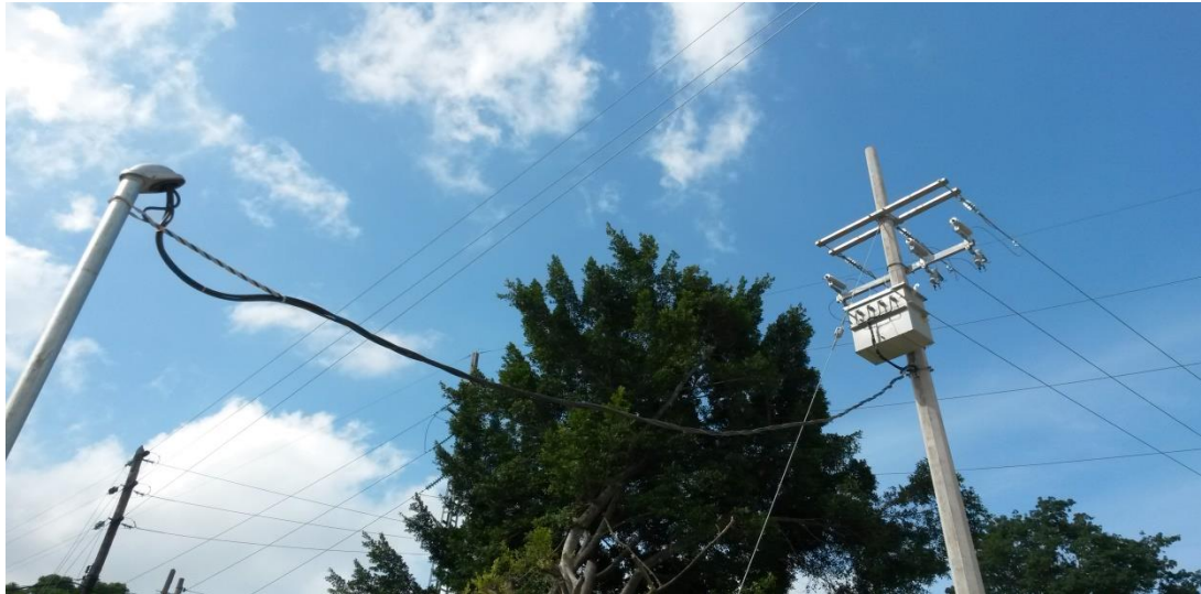
Fig. 3.3.1 transformador y acometida aérea.
