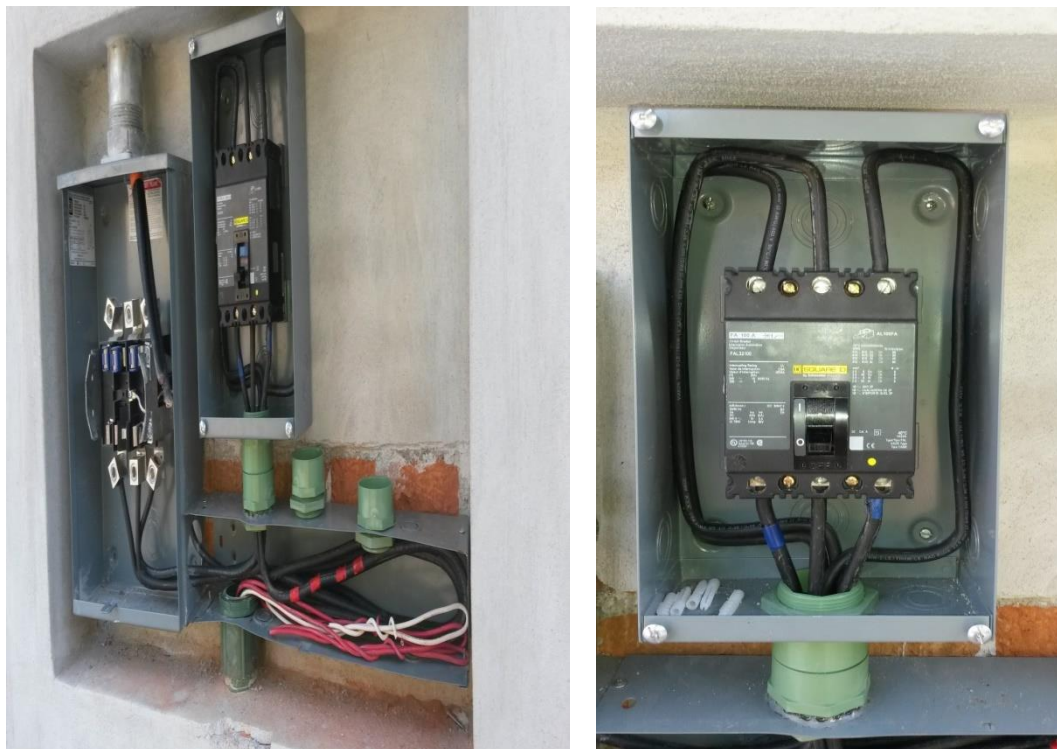
Fig. 3.2.3 Conexión del Interruptor Principal. Interruptor termo magnético FAL32100.
