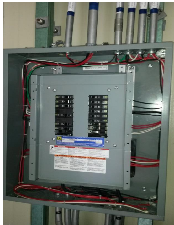
Fig. 3.3.3 tablero de distribución.
