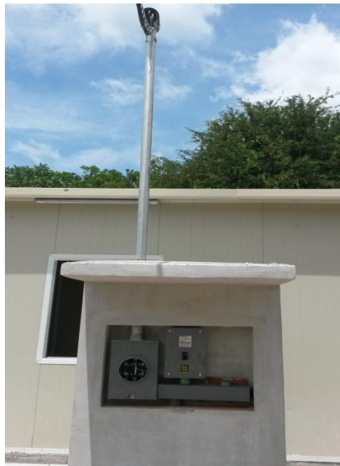
3.3.2 lector eléctrico trifásico e interruptor principal.
