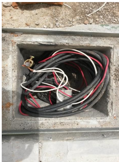
Fig. 3.2.5 conexión de a tierra física.
