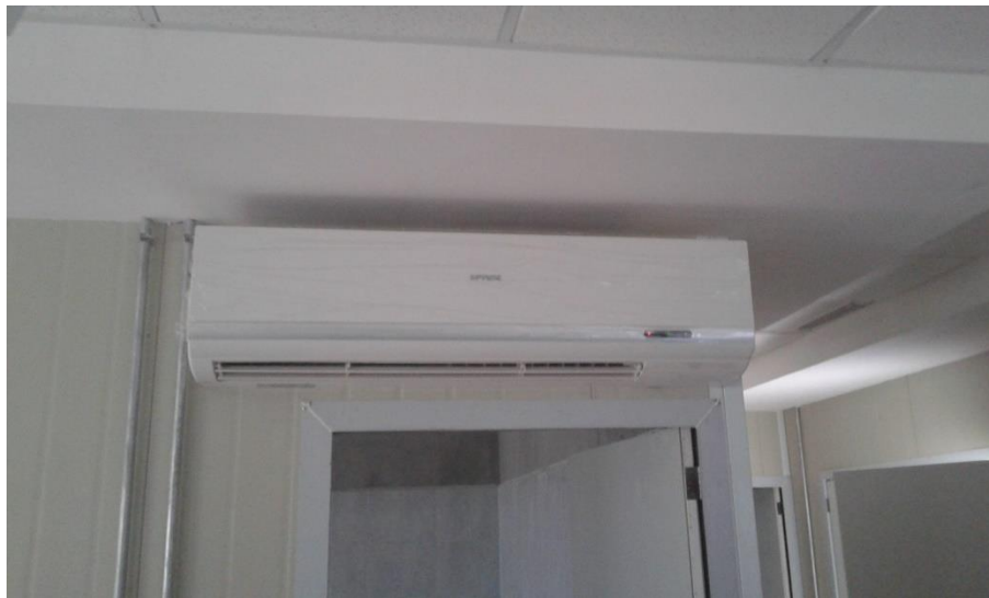
Fig. 3.2.9 Instalación de aire acondicionado. Equipo condensador mini split 1 ton.
