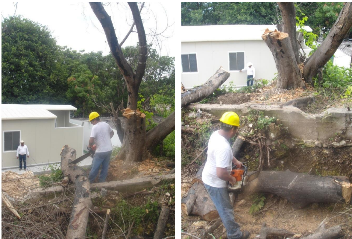
Fig. 3.1.3 Eliminación de árboles para la ejecución de la brecha para media tensión.
