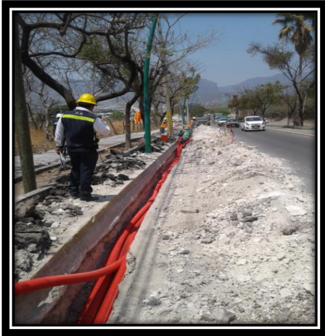
Figura 3.33.-Ductos en “arroyo”.
