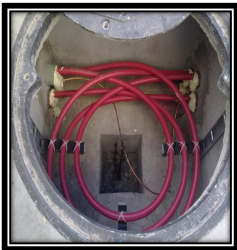
Figura 2.22.-Cables con Soportería.
