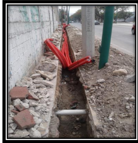
Figura 3.34.-Ductos en “banqueta”.
