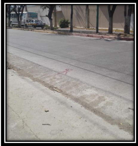
Figura 3.8.- Tramo arroyo cortado.
