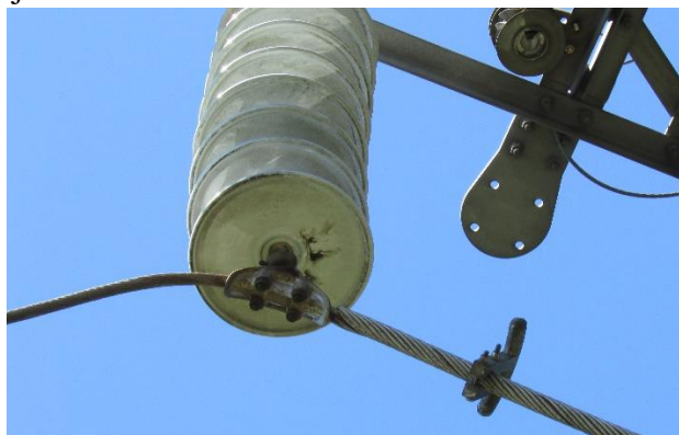
Figura 33. Apartarrayo tipo protecto-line flameado.
