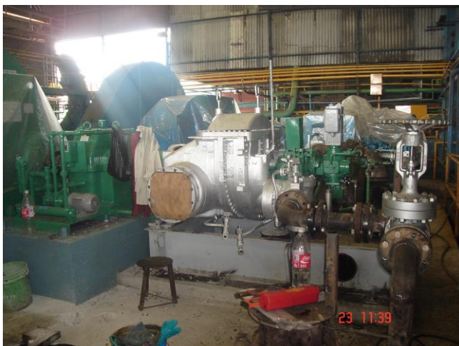
Fig. 1.6.5-3 Turbinas de Alta Presión.
