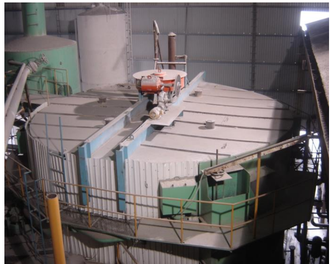
Fig. 1.6.7-2 Clarificación del jugo
