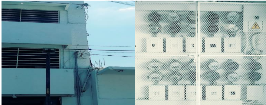
Figura 3.23. Concentración interior de medidores.
