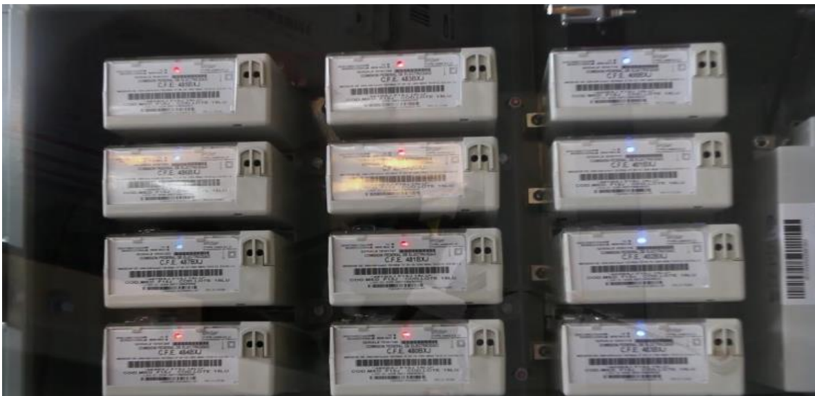
Figura 3.32. Prueba de gabinete con medidores MREX.
