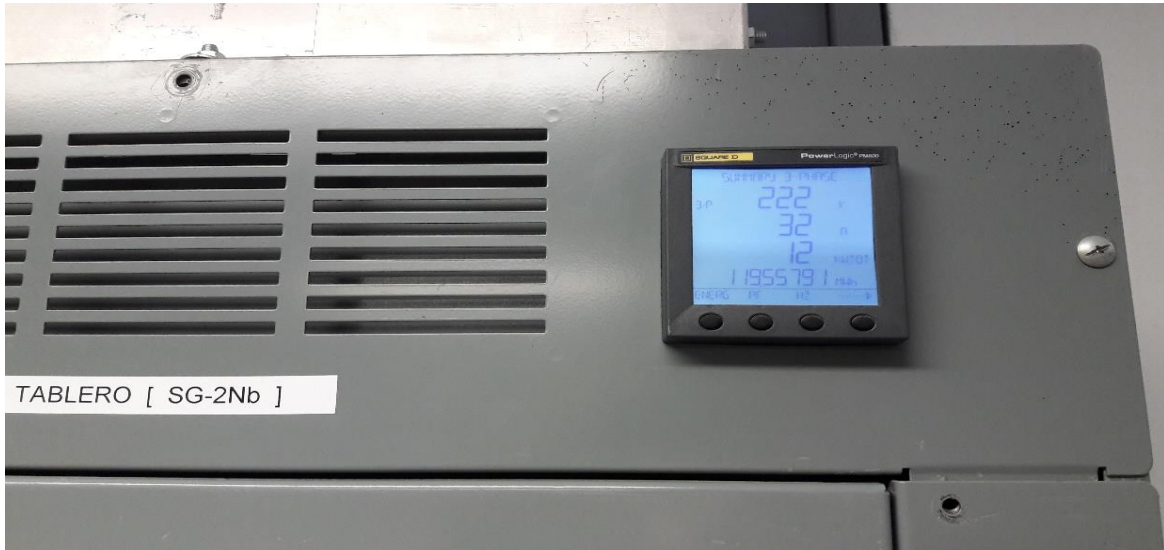
Fig. 48.- Central de medición PM800 en tablero sub general
