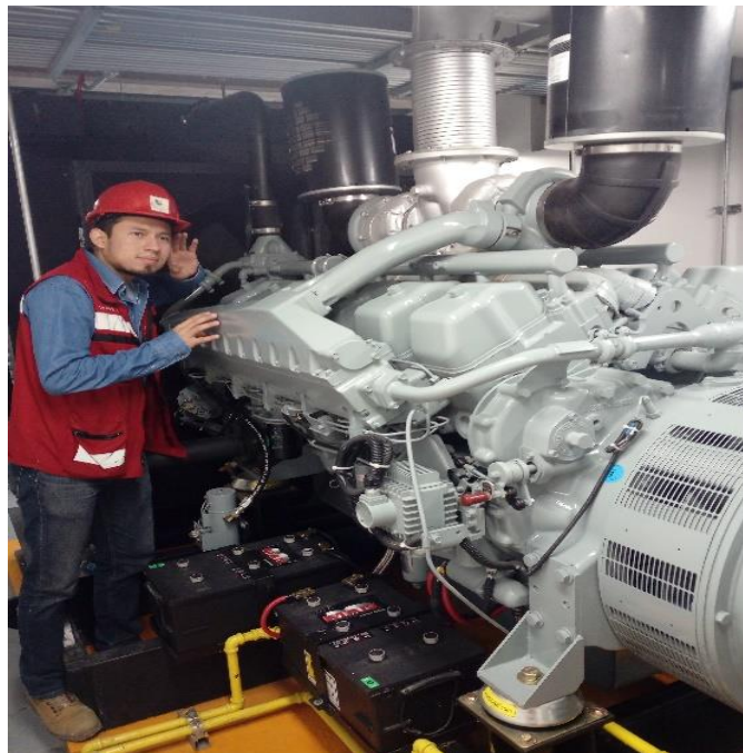
Fig.34 - Inspección del turbo compresor
