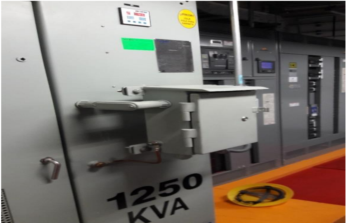
Fig. 39.- Transformador normal principal
