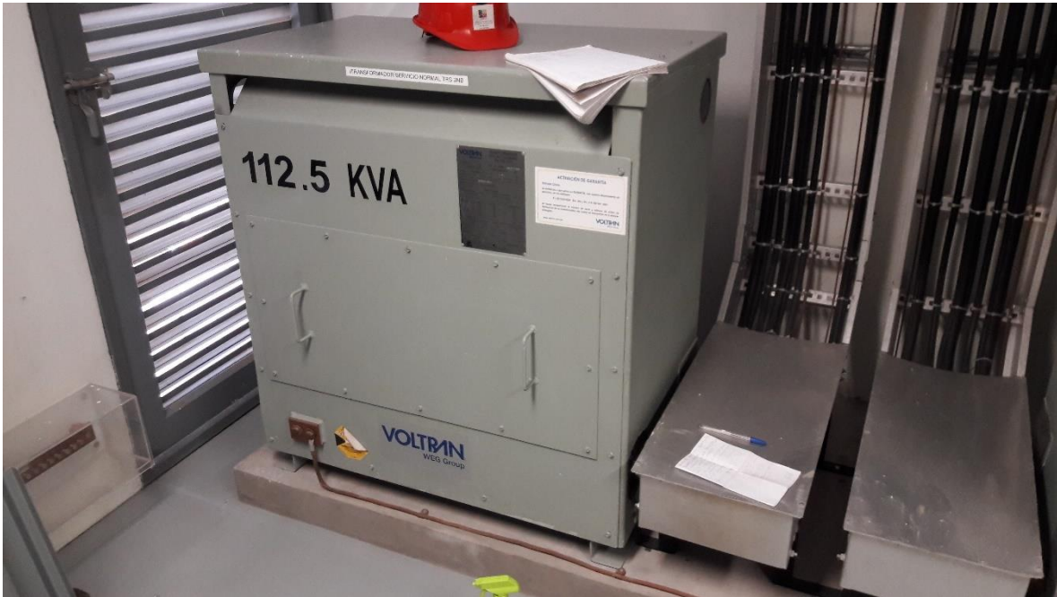
Fig. 51.- Limpieza y monitoreo del transformador
