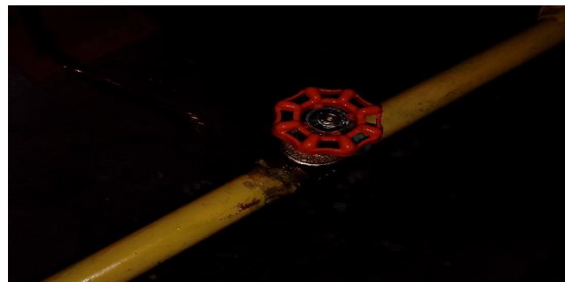
Fig. 21 - Grifo de drenaje
