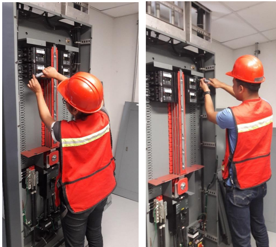
Fig. 52 - Apriete en las conexiones del tablero
