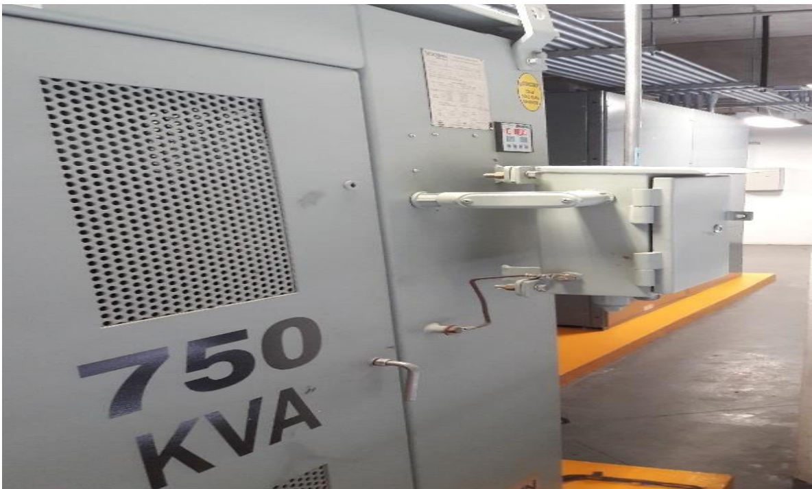
. Fig. 40- Transformador de emergencia principal
