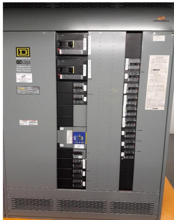
Fig. 43.- Tablero general (tipo distribución)
