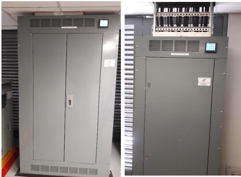
Fig. 47.- Tablero sub general normal SG-1Na
