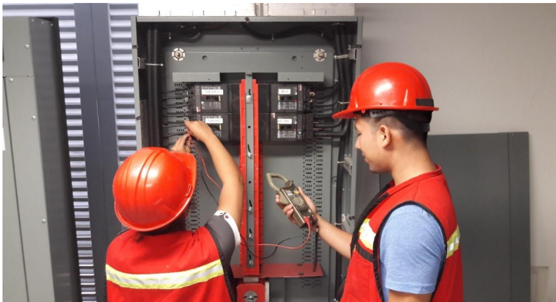
Fig. 54 - Medición de voltaje y amperaje en los interruptores del tablero
