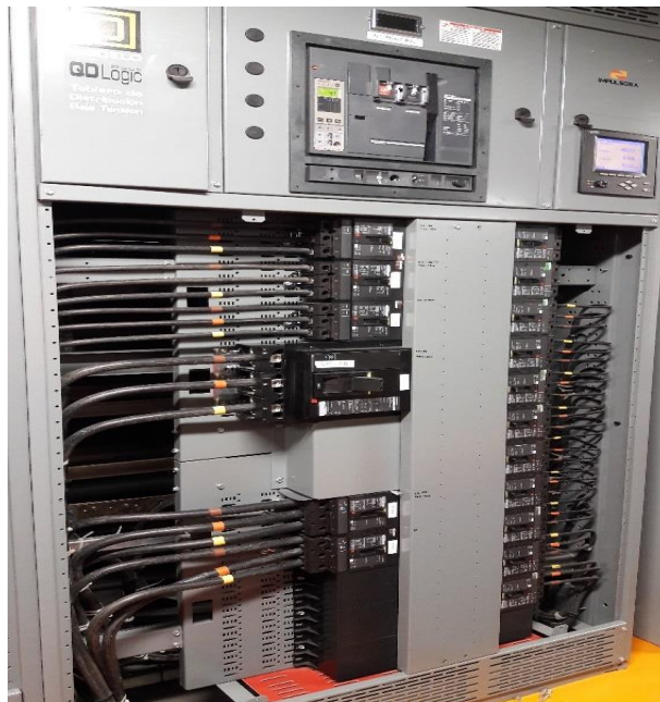
Fig. 42.- Tablero general (tipo combinación)
