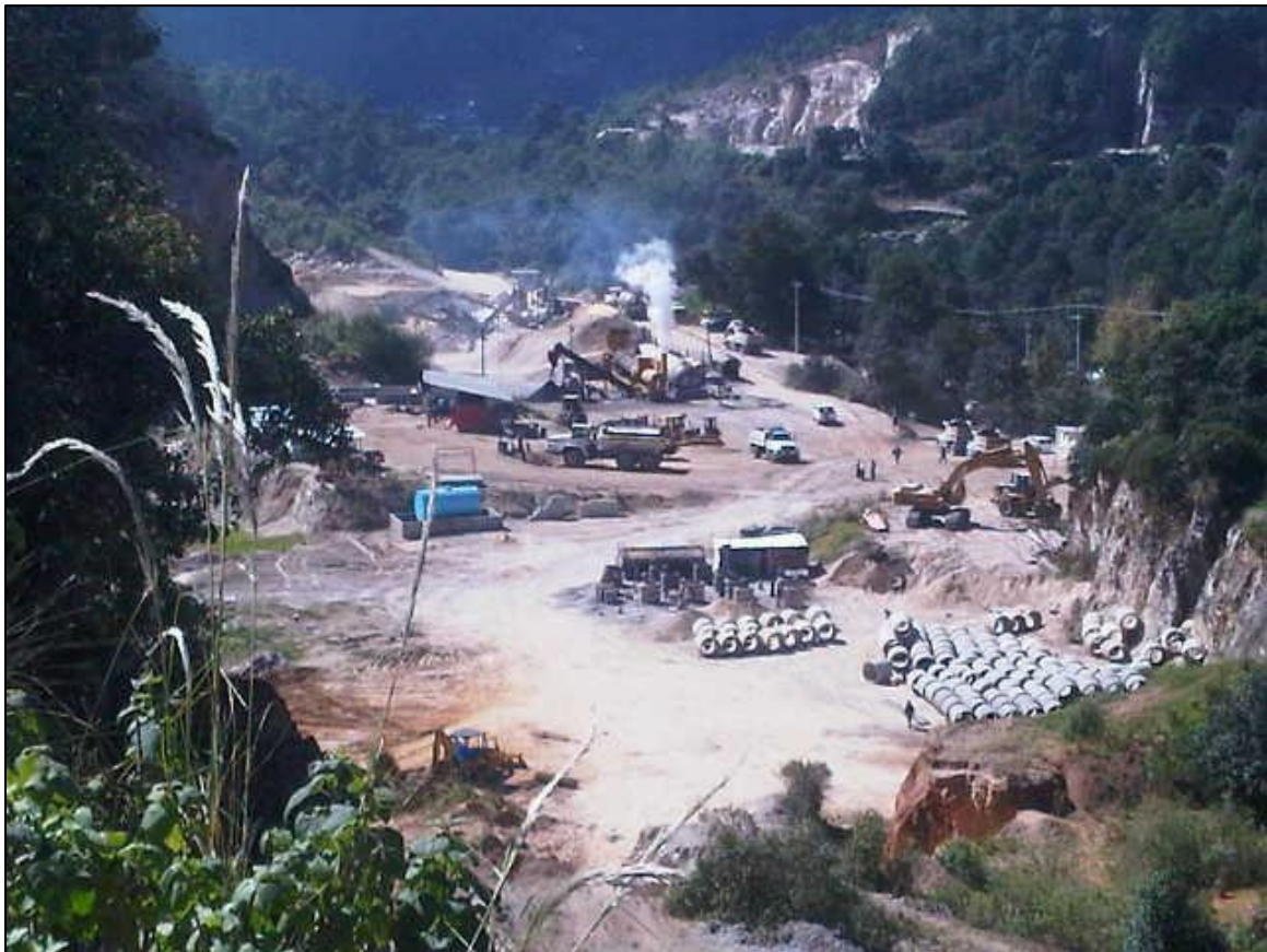
Fig. 4.1.- Planta "las Peras", ubicada en la ciudad de San Cristóbal de las casas, ahí se produce tubería hidráulica de concreto, entre otros productos.
