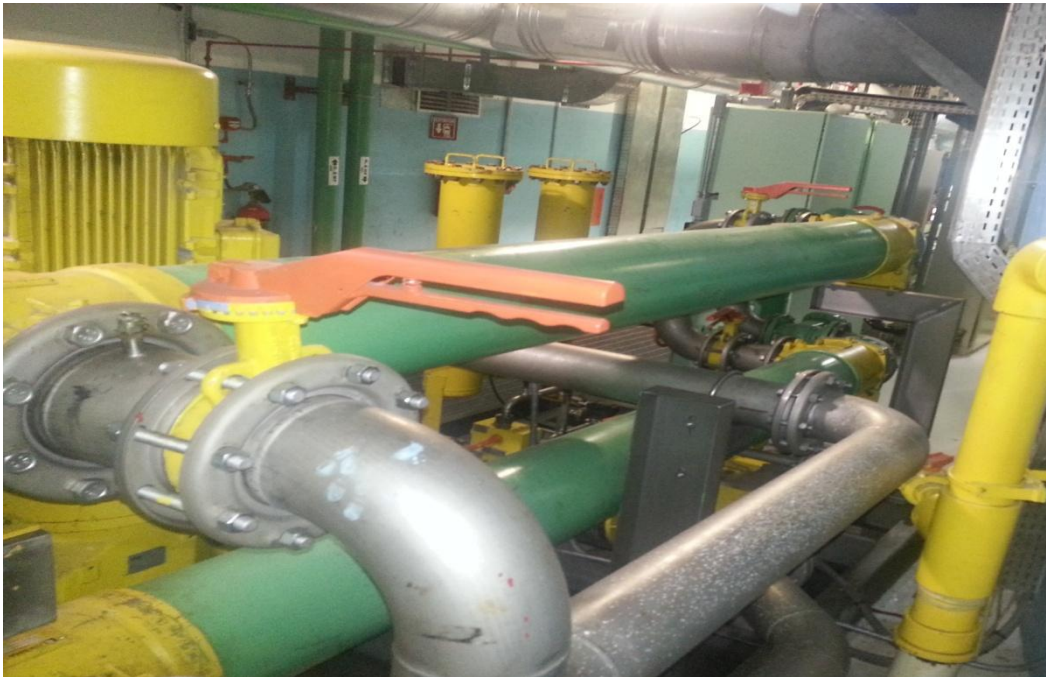
Imagen 1.3 Intercambiadores de calor de la chumacera combinada de las unidades de la segunda etapa.
