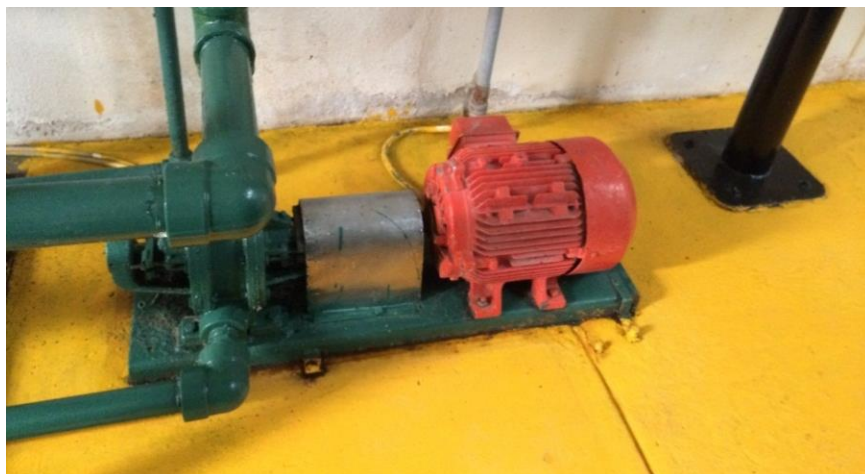
Figura 2.5 Bomba de alimentación
