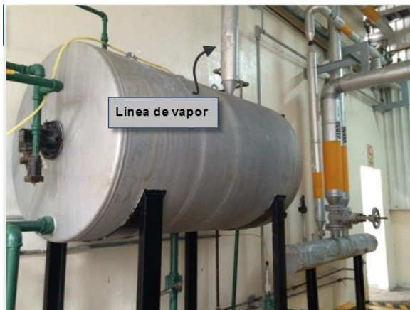
Figura 1.3 Depósito de condensados y línea de alimentación de vapor puro
