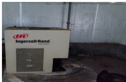
Imagen#6 Secado del aire comprimido
