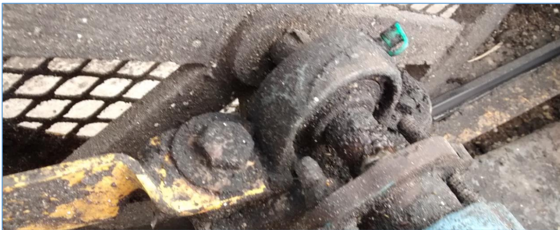
Figura 4.1.- Chumacera operando en mal estado.
