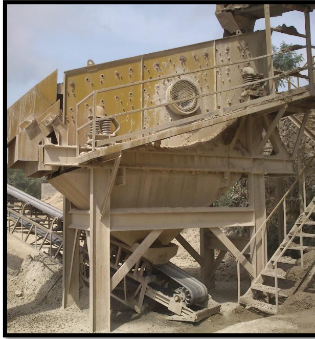
Fig. 3.9. Criba de despolve en Planta 2.
