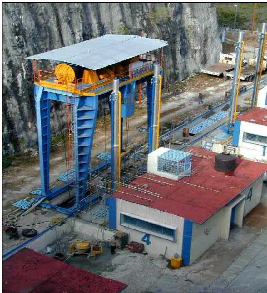
Figura 8.- Casetas de control de obra de toma y grúa pórtico para operar las compuertas auxiliares.
