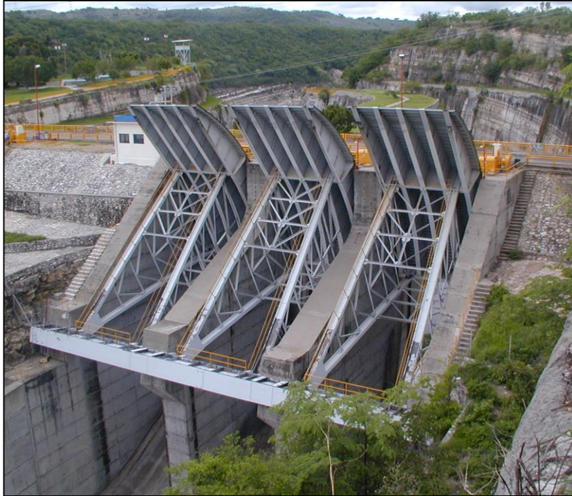
Figura 6.- Compuertas de vertedores
