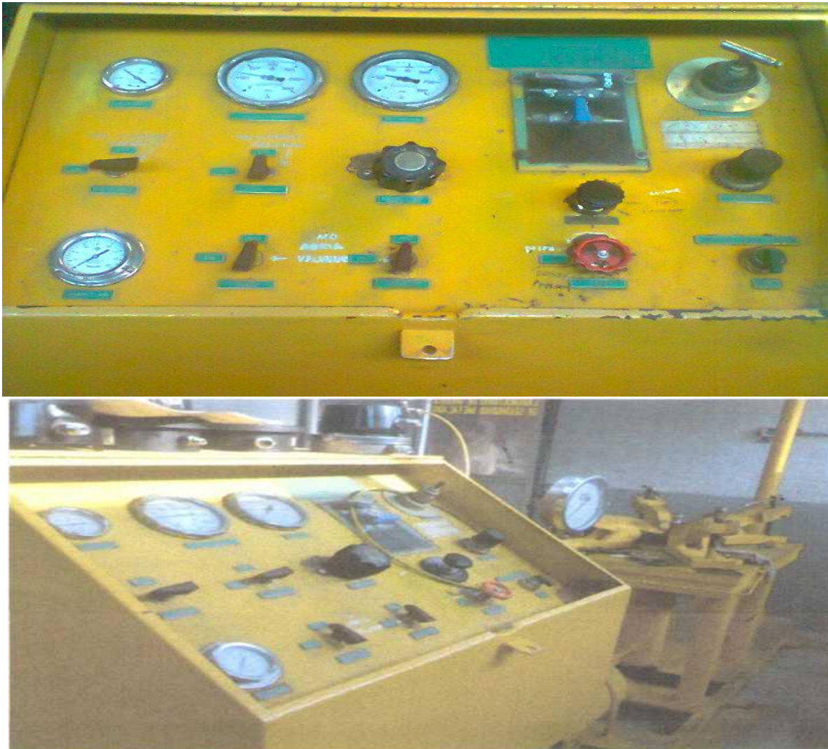
Fig.15 Banco de pruebas del taller de mantenimiento mecánico Verificación de la presión de ajuste y diferencial de cierre.
