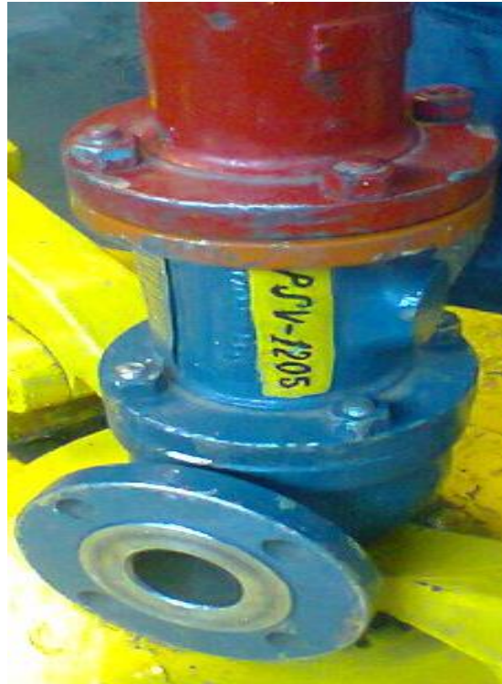
Fig.5 Válvula de alivio de la planta de óxido de etileno.
