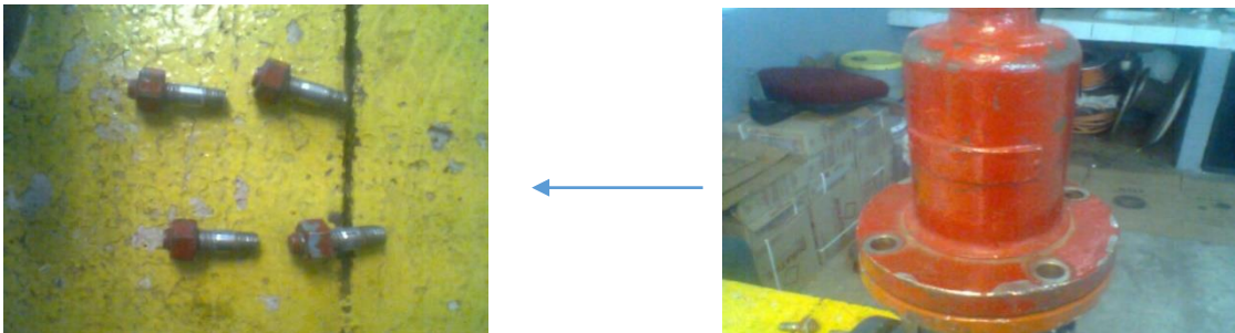
Fig.20 Capuchón y espárragos correspondientes de una válvula de seguridad de la planta de óxido de etileno.
