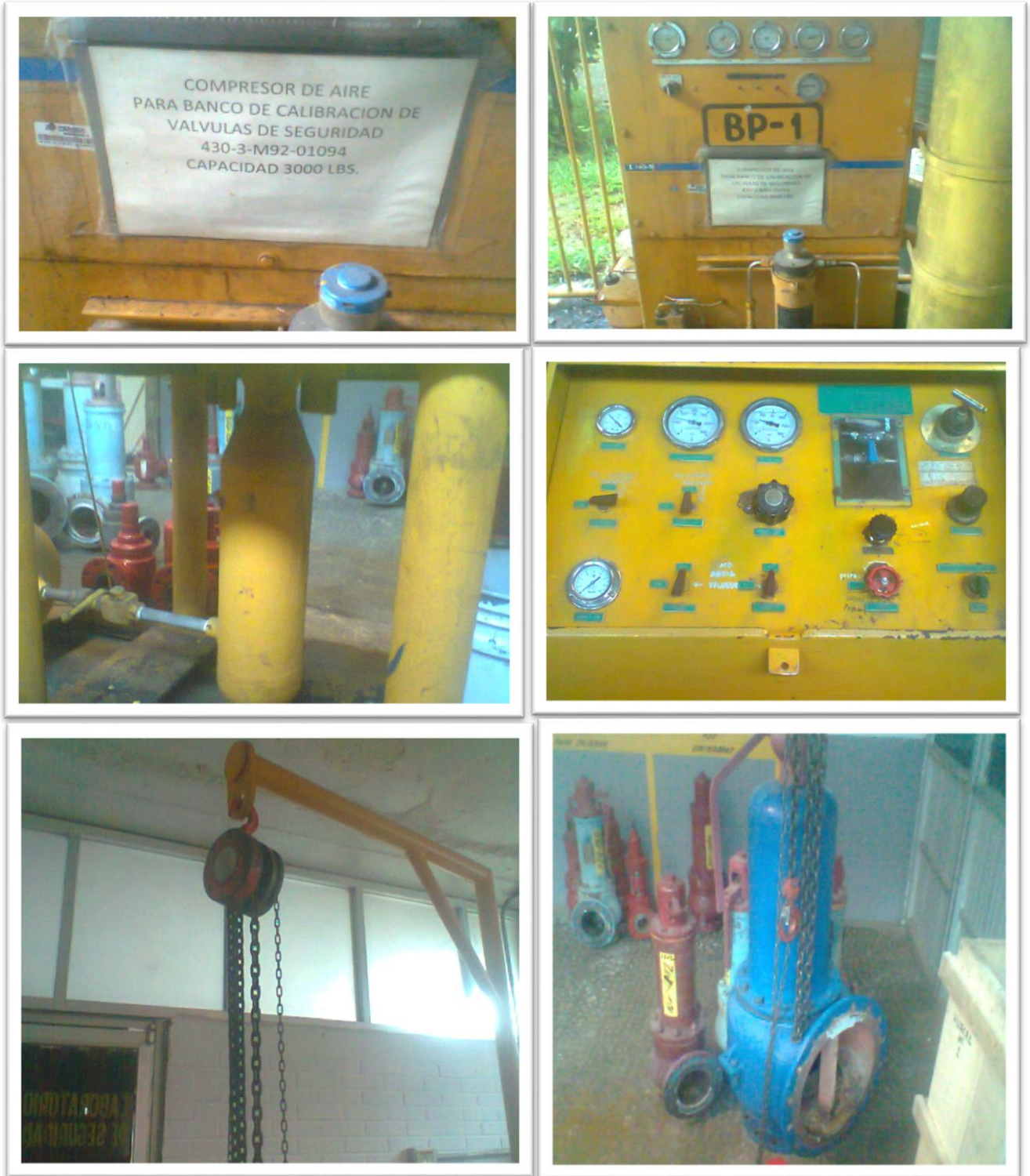
Fig.4 Equipos del laboratorio de calibración de válvulas de seguridad.
