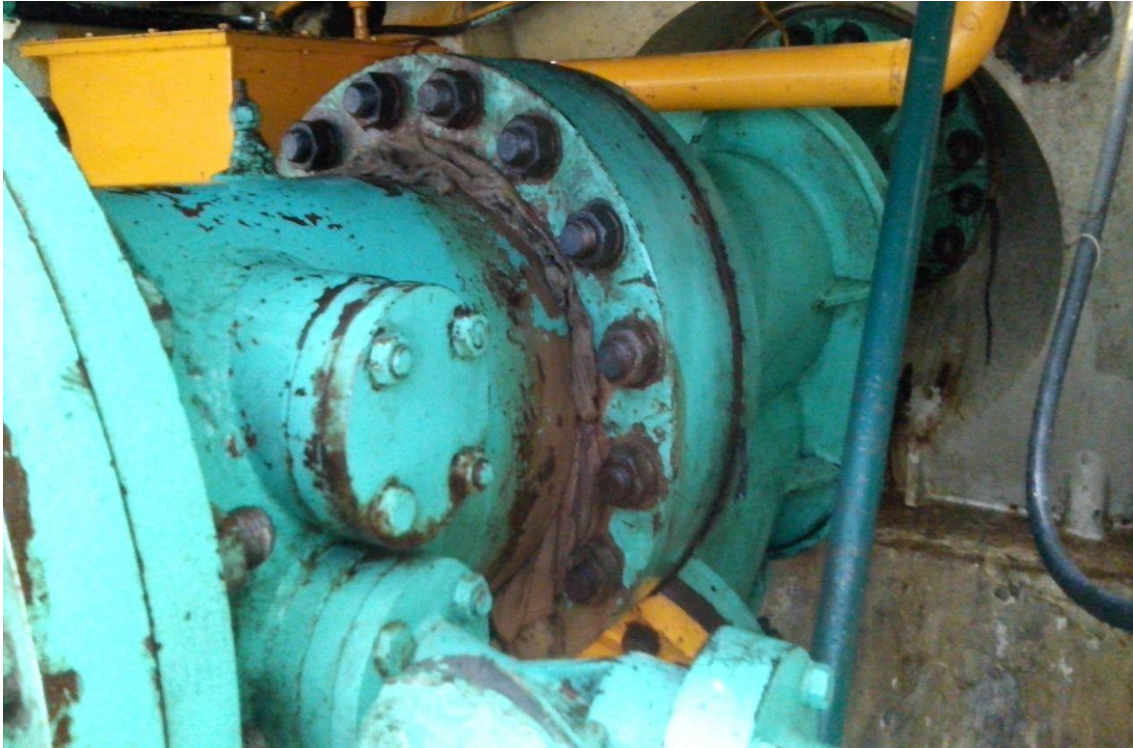
Fotografía 3.1.- Tobera de la turbina.
