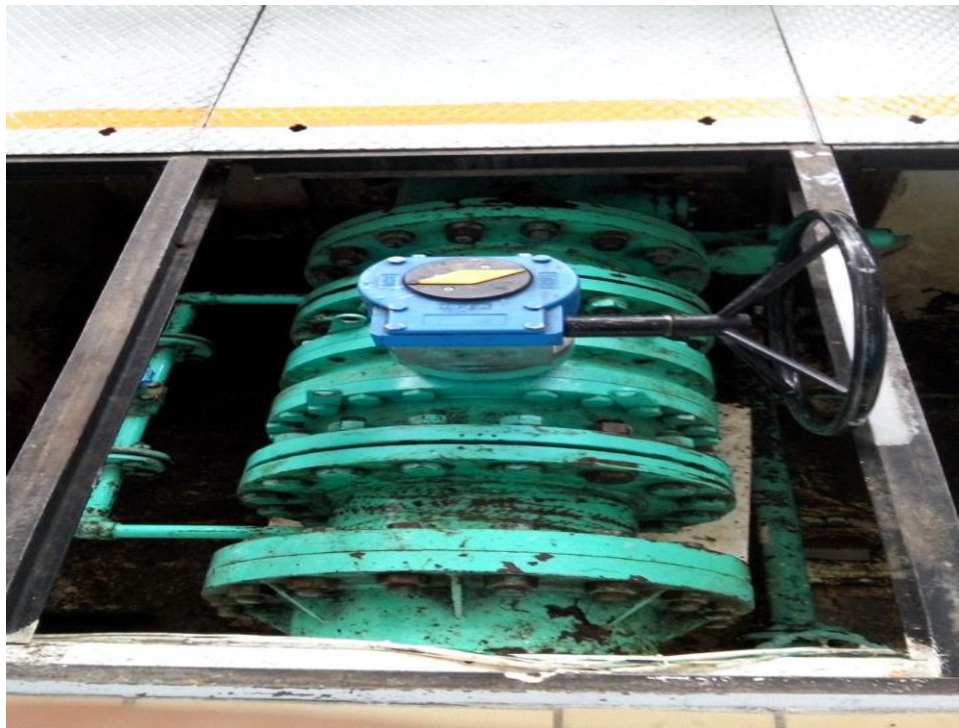
Fotografía 3.10.- Volante de la válvula esférica.
