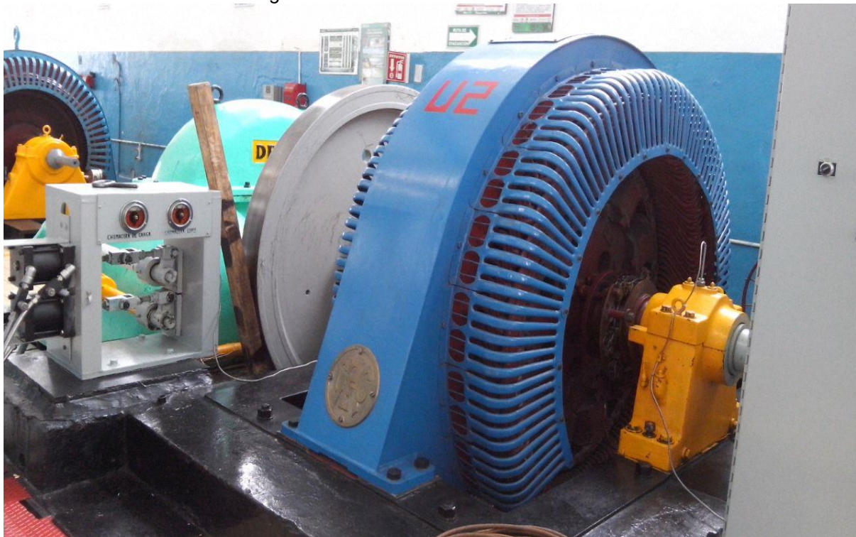
Fotografía 3.11.- Generador de la unidad no. 2.
