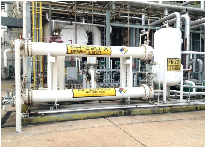
Ilustración 11-Sistema de enfriamiento de aceite
