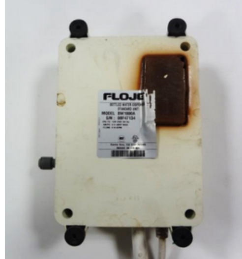
Imagen 1.7 Daño del transformador
