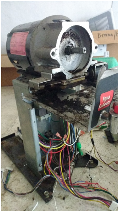
Imagen 1.1 Problemas ocasionados por mal mantenimiento
