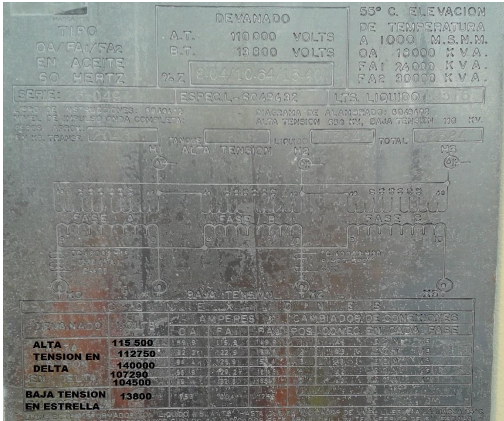
Figura 2. 2 Placa del transformador de subestación Tuxtla 1
