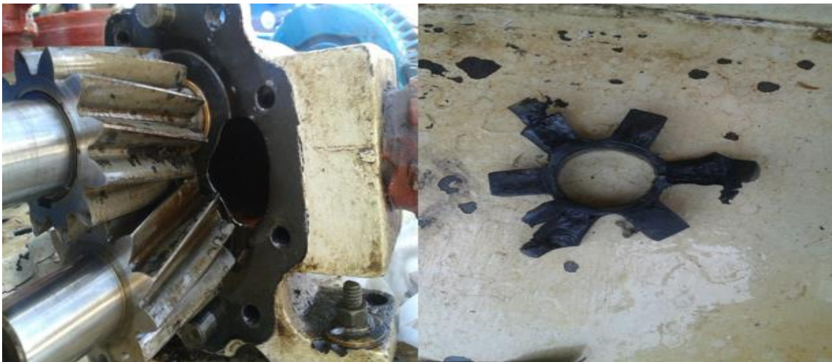
Figura 3. 13 Engranes y acoplamiento en mal estado
