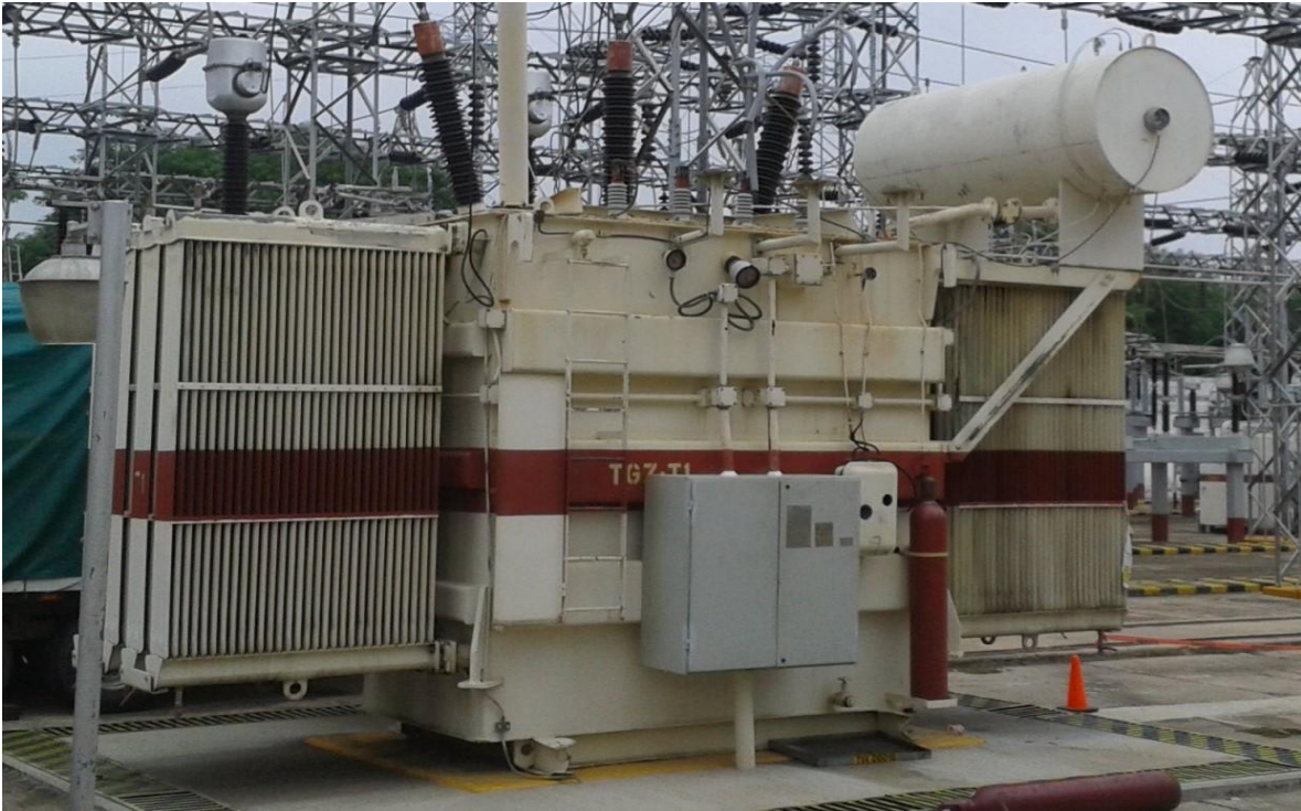
Figura 2. 1 Transformador de (30 MVA) subestación Tuxtla uno, CFE
