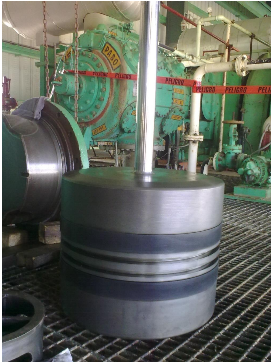
Fig. 46 Pistón desmontado del compresor BC-304-C.
