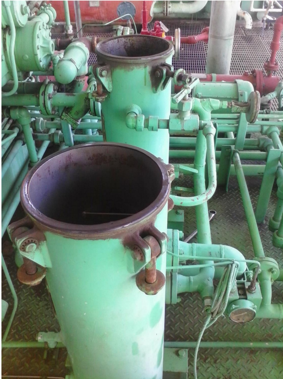
Fig. 41 Filtro de aceite de compresor BC-301-B
