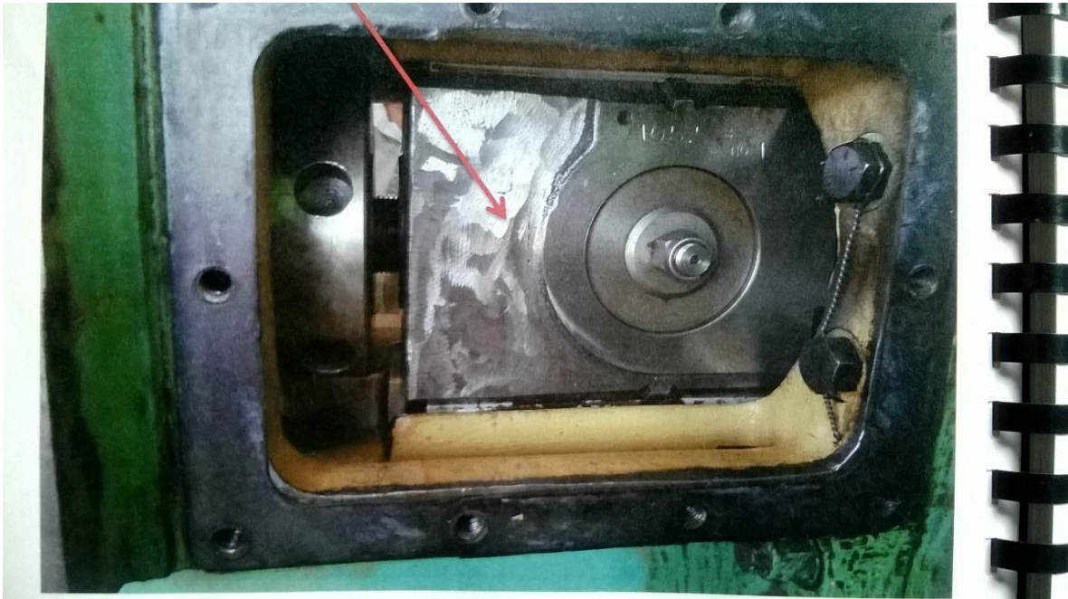
Fig. 47 Cruceta en mal estado por desgaste.
