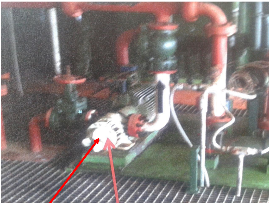
Bomba auxiliar de lubricación
