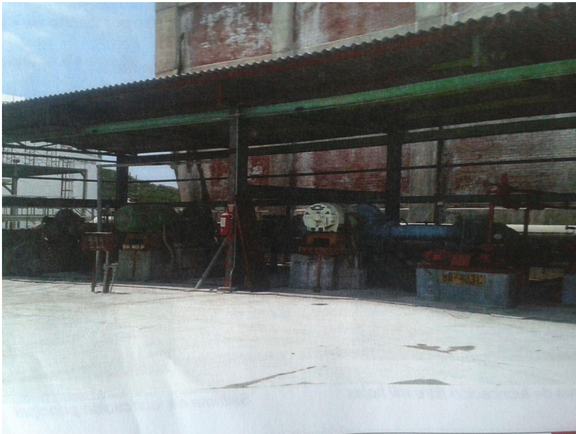
Fig. 63 Sistema de enfriamiento para los compresores, así mismo para el aceite. (Por medio de bombas).
