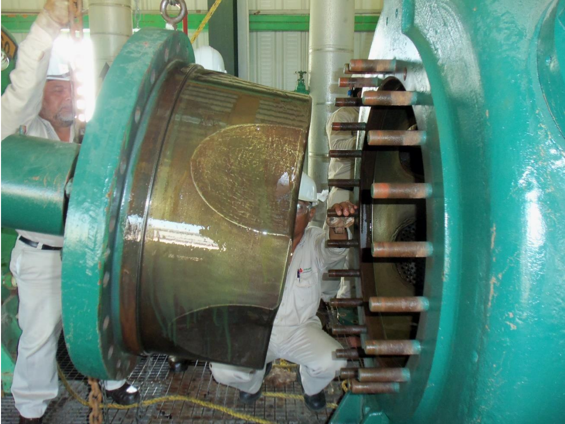
Fig. 49 Cabezote del compresor. (Solo necesita mantenimiento)
