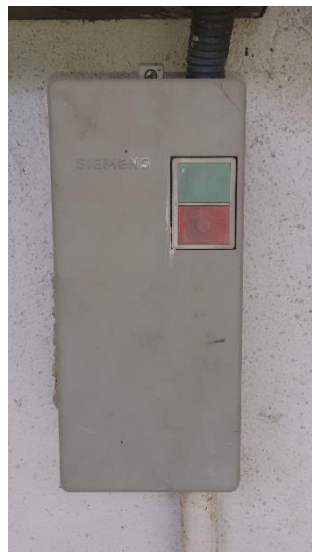
Fig. 12 Arrancador Automático para el compresor
