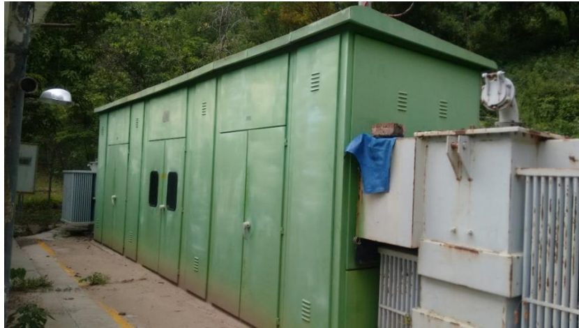
Fig. 7 Subestación Eléctrica del Tipo Intemperie Compacto.
