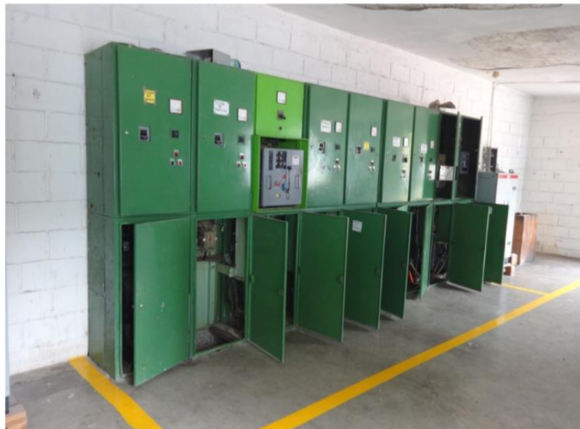
Fig. 8 Cuarto de Control de Motores (CCM)
