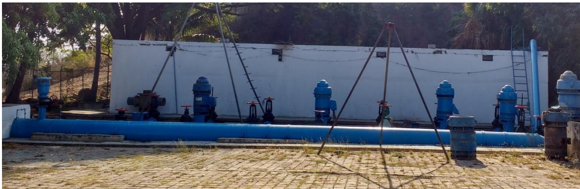
Fig. 6 Tanque de Almacenamiento de la Planta No.3 Nueva
