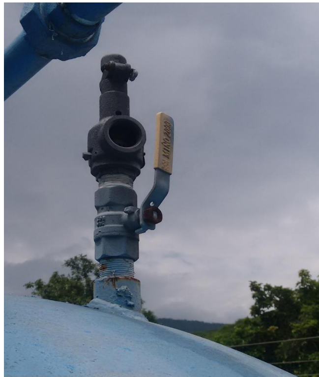
Fig. 15 Válvula de seguridad
