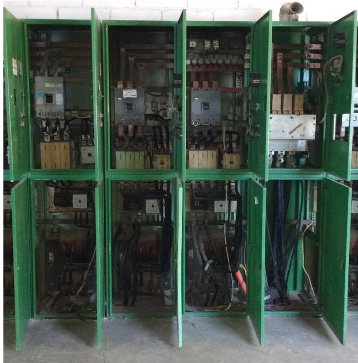
Fig. 9 Interior del Centro de Control de Motores (CCM)
