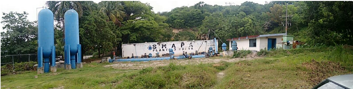
Fig. 2 Planta de Rebombeo No.3 Nueva.
