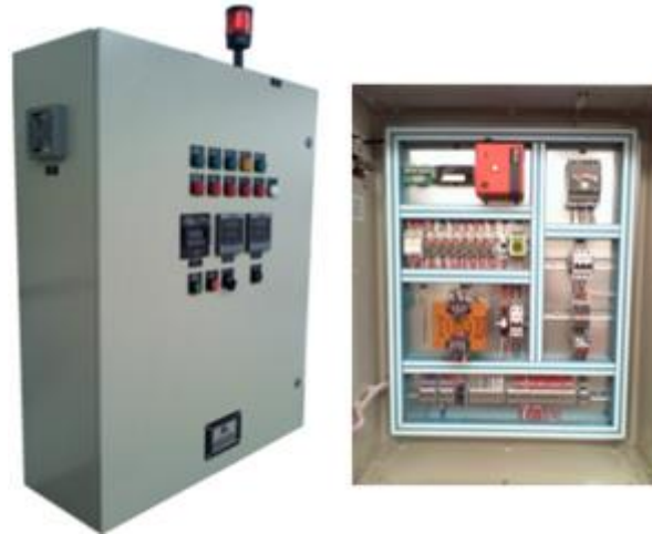
Figura 49. Gabinete de control.
