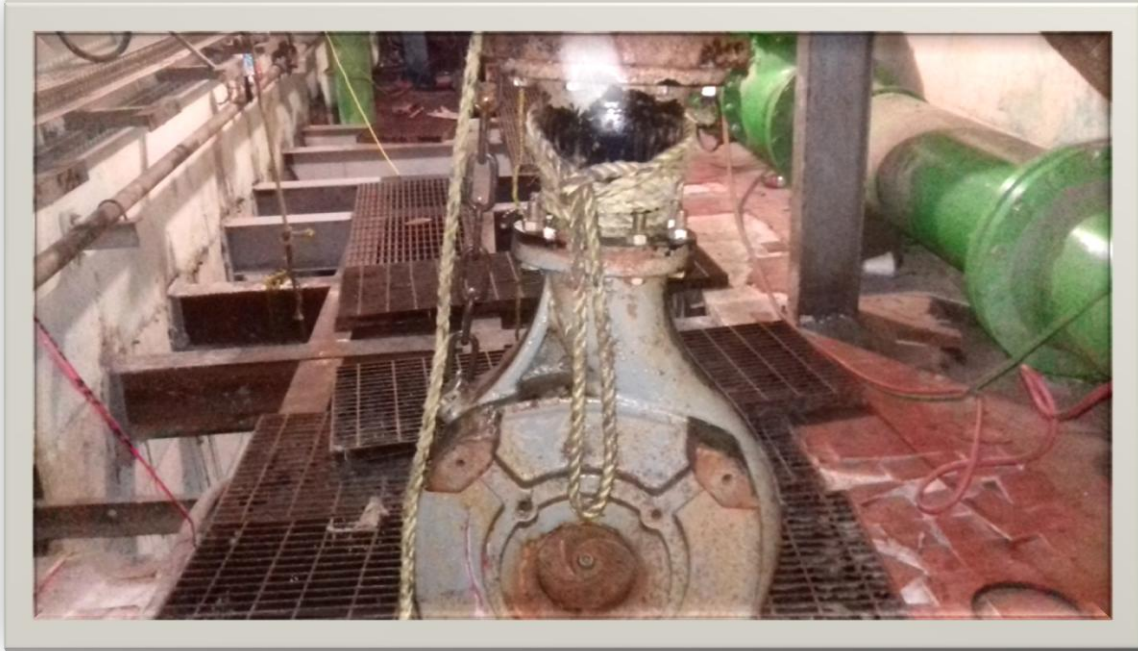
Figura 29. Bomba usada, retirada del cárcamo
