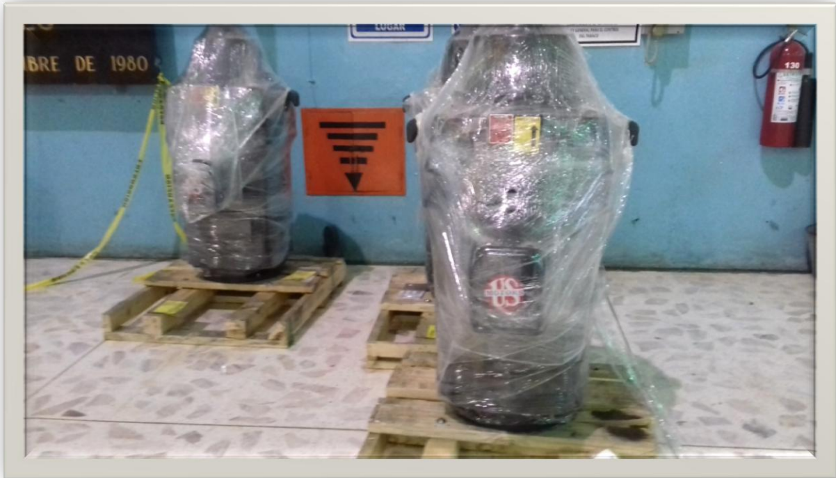
Figura 32. Motores eléctricos para bombas centrifugas.
