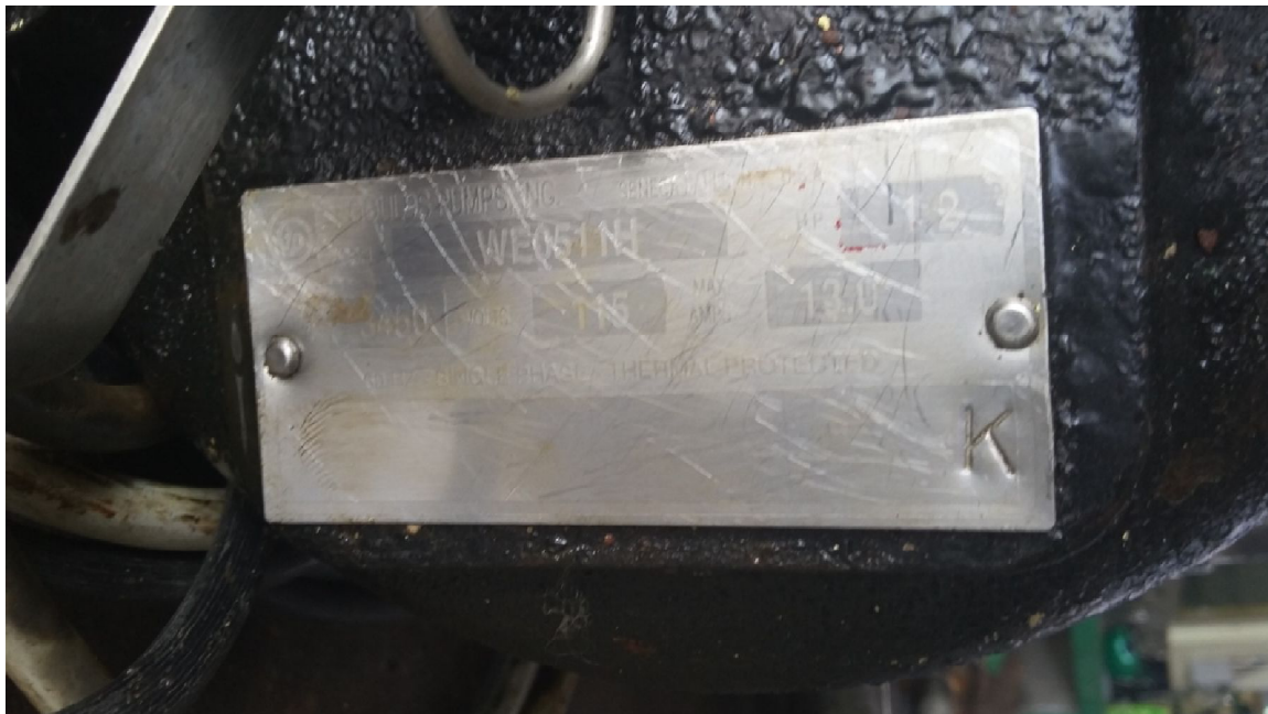
Figura 13.-Bomba de ½ HP con el que actualmente opera la Central.
