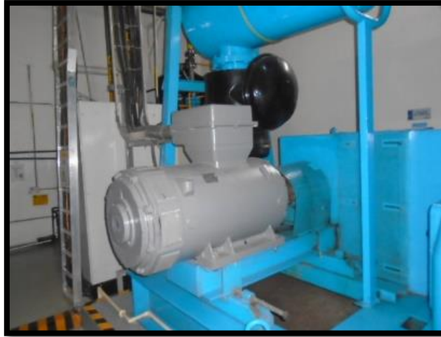
Imagen 30 "Motor eléctrico del Compresor AF2"
